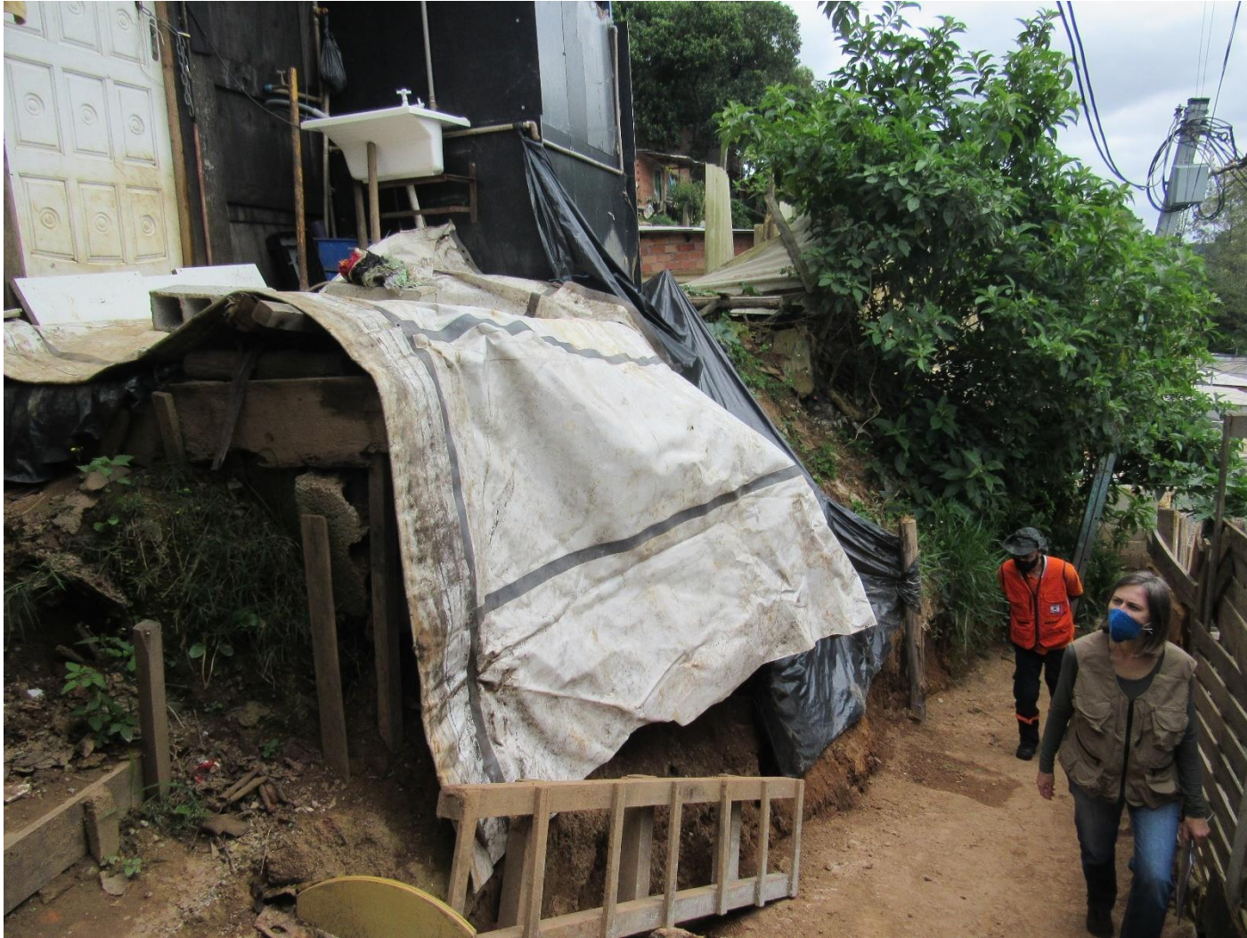
FC-SBC44_S2-02 – Local de possível deslizamento coberto por lonas.
