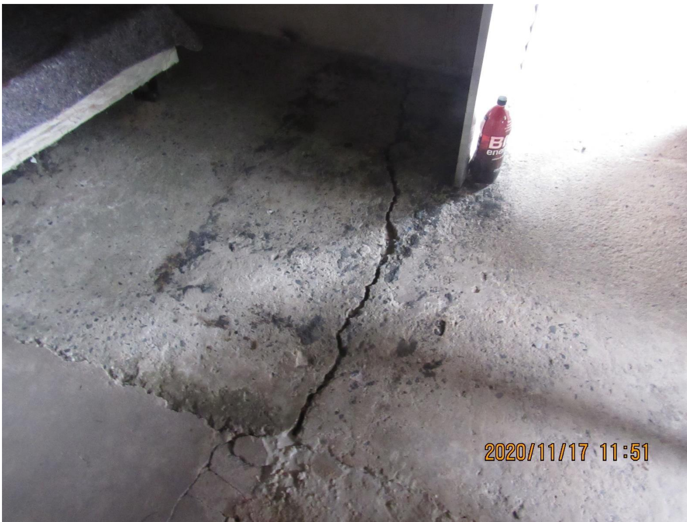
FC-SBC37_S2-03 – Destaque para as trincas no chão da casa indicada na foto FC-SBC36_S2-01.
