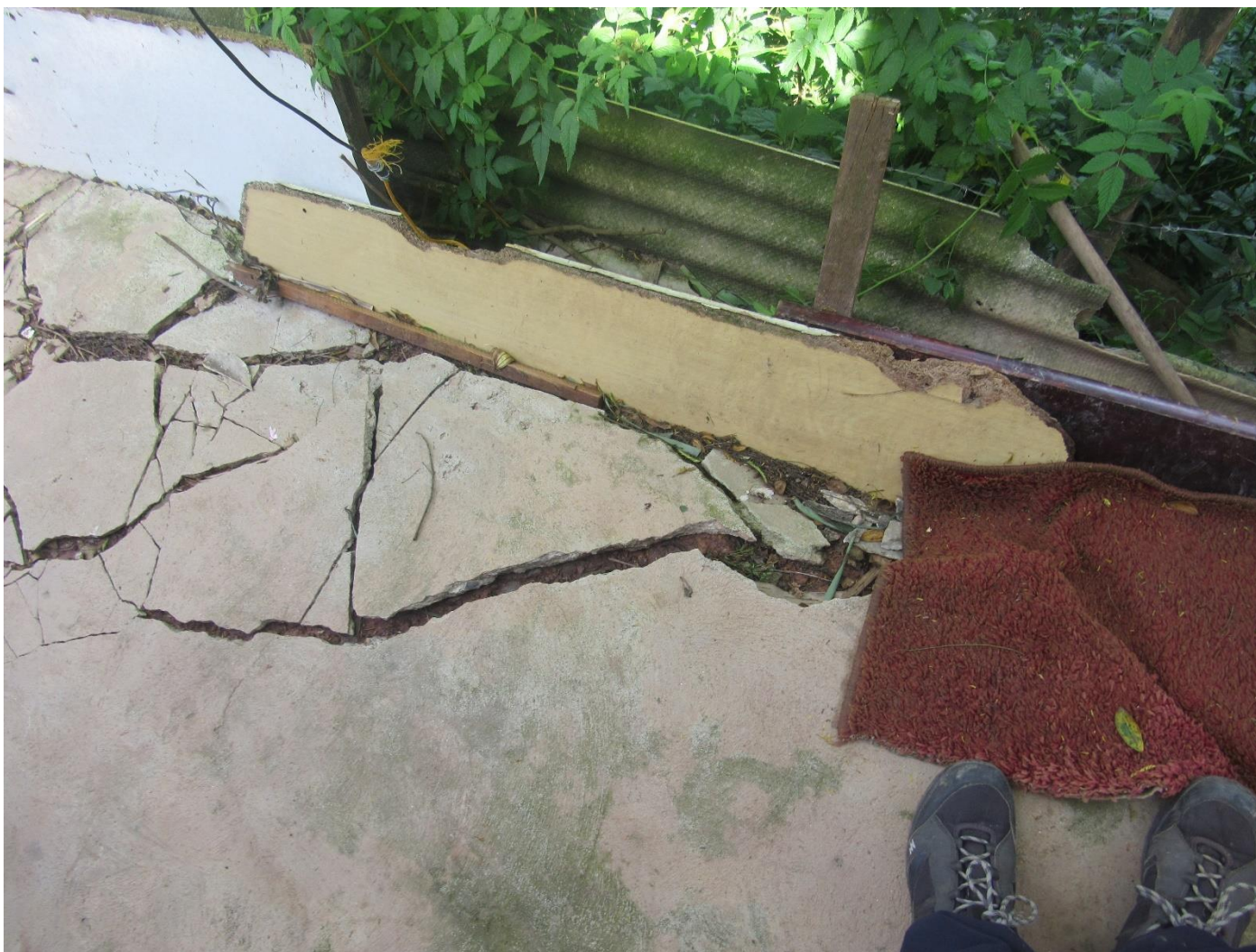
FC-SBC23_S2-02 – No setor é possível observar pequenos processos relacionados com aterros mal compactados e cortes. Observa-se na foto uma trinca no terreno.
