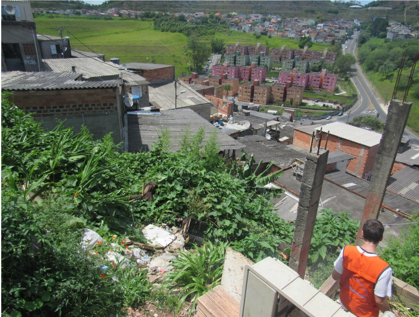
FC-SBC23_S5-02 – Logo a jusante da encosta vegetada está a moradia indicada para remoção provisória.
