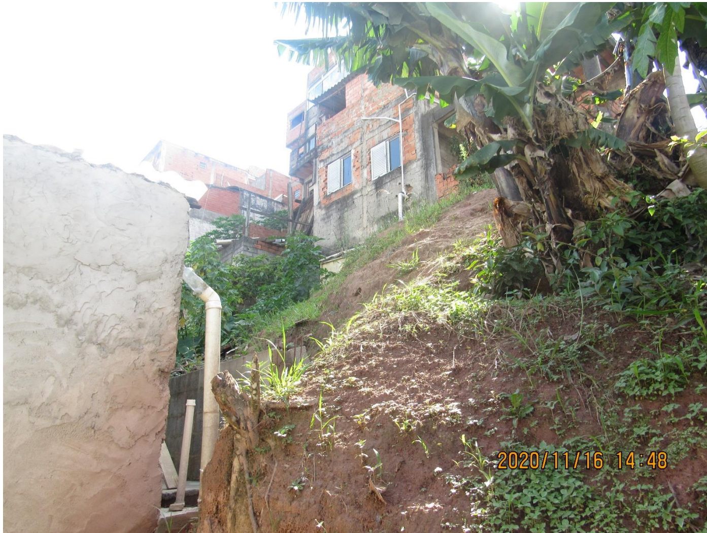
FC-SBC33_S2-01 – Talude de corte no fundo das casas da Rua das Araras. Situação que se repete nessa faixa de casas.
