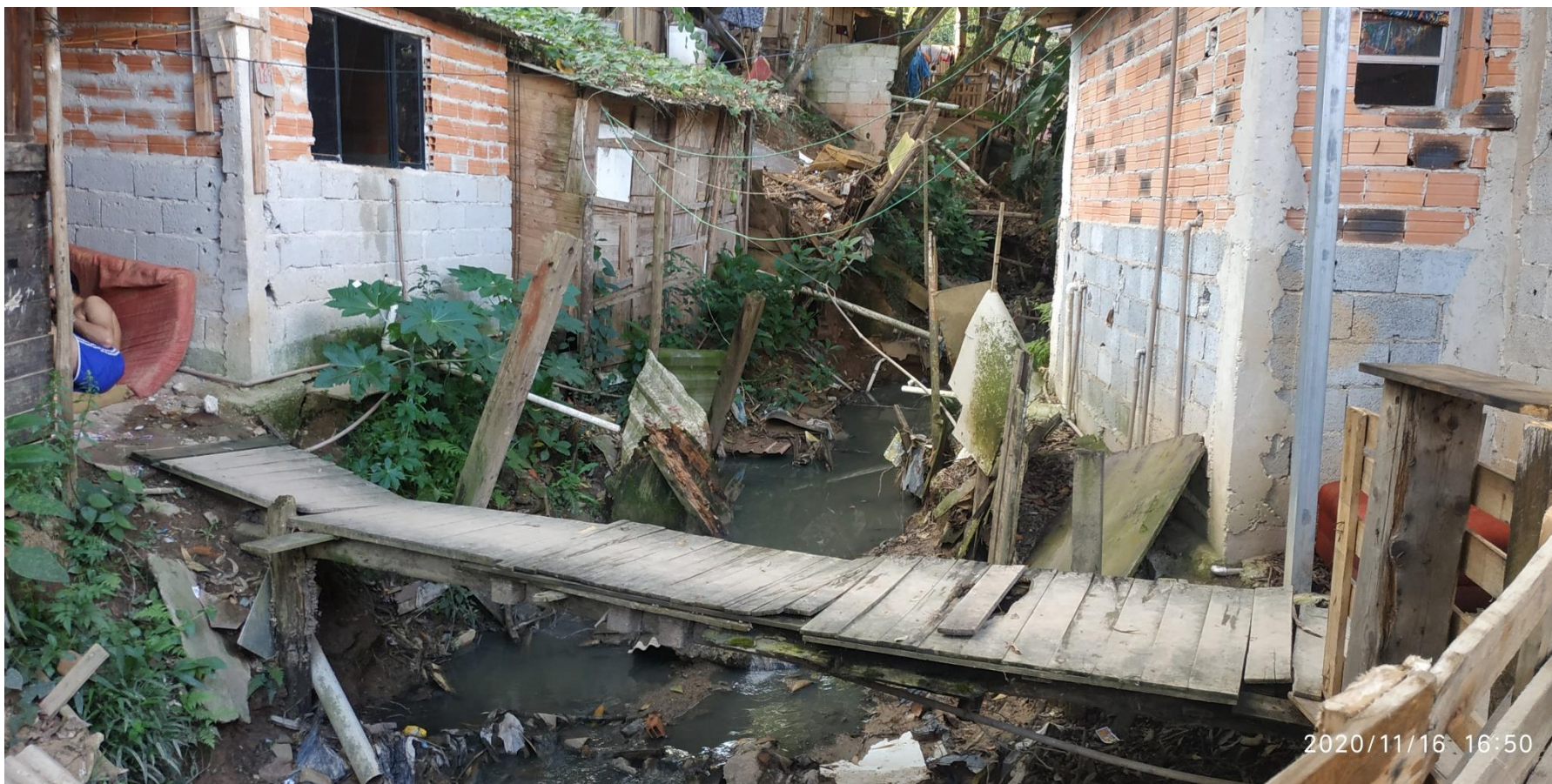
FC-SBC34_S3-04 – Destaque para precariedade das casas. Situação que se repete ao longo de todo o setor.
