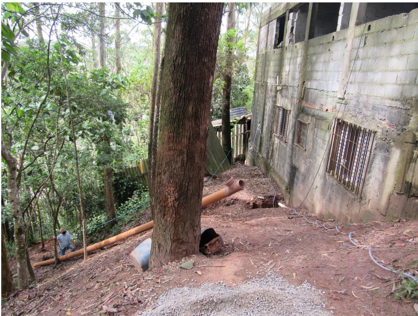
FC-SBC21_S1-02 – Vista para parte aterrada a jusante das edificações localizadas na crista da encosta.
