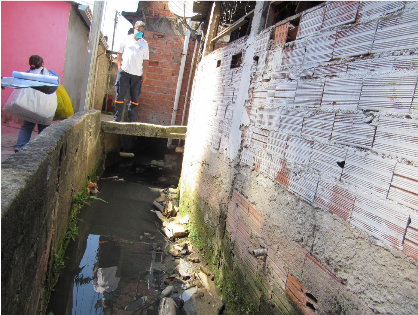
FC-SBC39_S1-01 – Destaque para situação que ocorre em alguns trechos do setor, com o canal passando por baixo das moradias.
