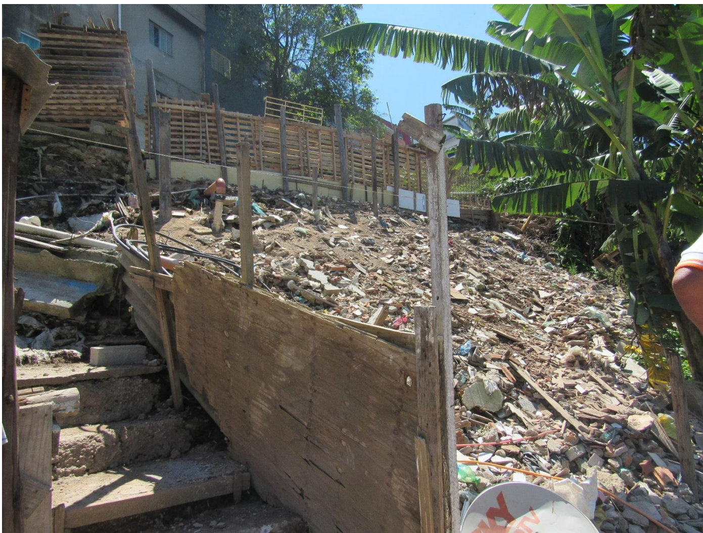
FC-SBC25_S1-03 – Outro local de descarte inadequado de material (lixo e entulho), entretanto, possivelmente foram demolidas casas e muitos escombros permanecem no local – parte superior esquerda do setor.
