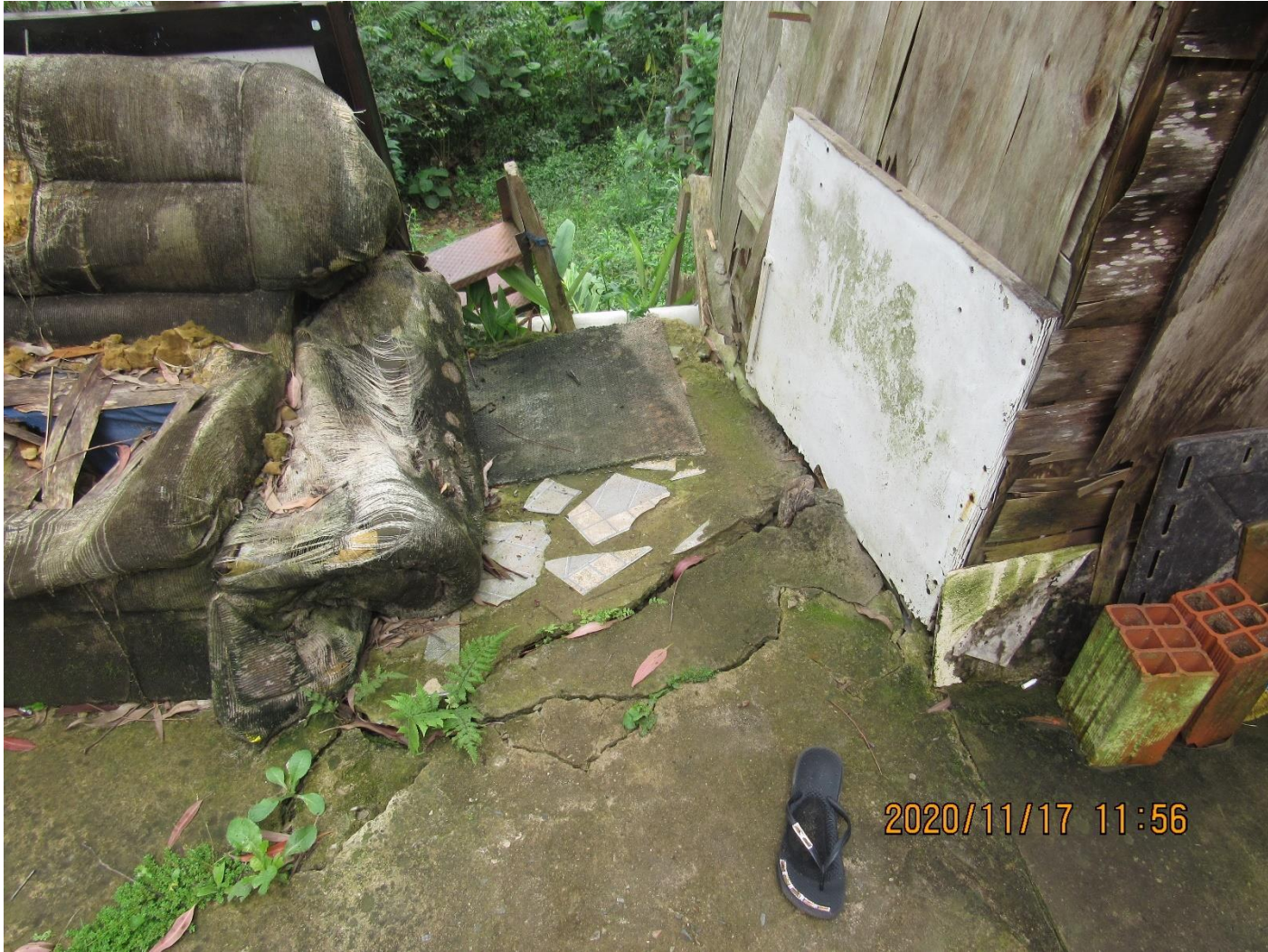
FC-SBC37_S2-04 – Destaque para as trincas no chão da casa indicada para remoção provisória localizada no canto esquerdo do setor.
