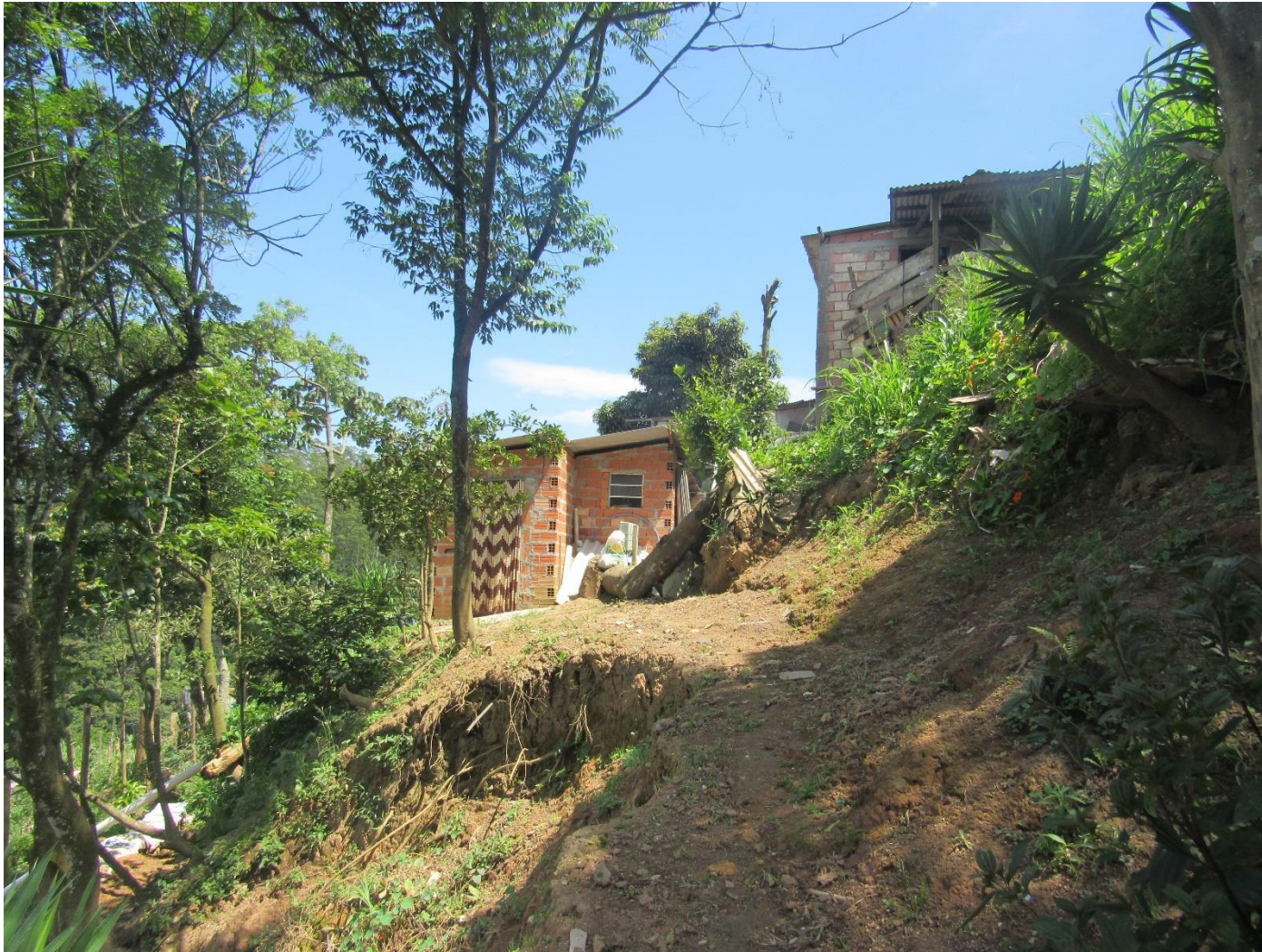
FC-SBC23_S3-01 – Degrau de abatimento no trecho superior do setor.
