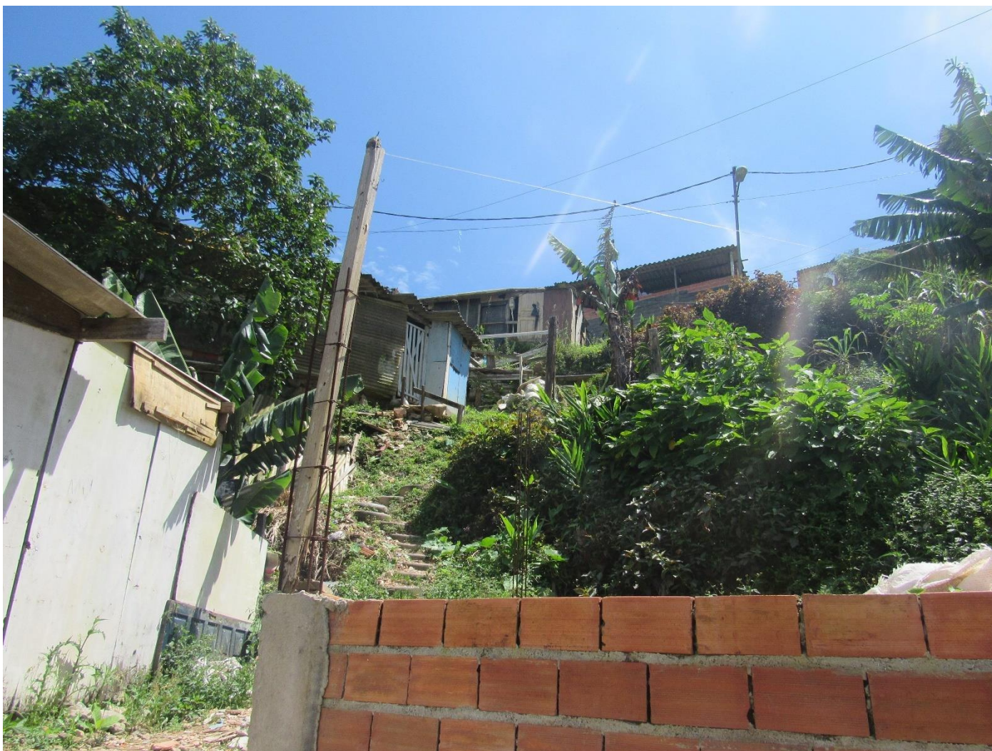
FC-SBC23_S4-02 – Vista para encosta no limite esquerdo do setor. Destaque para precariedade da escadaria.
