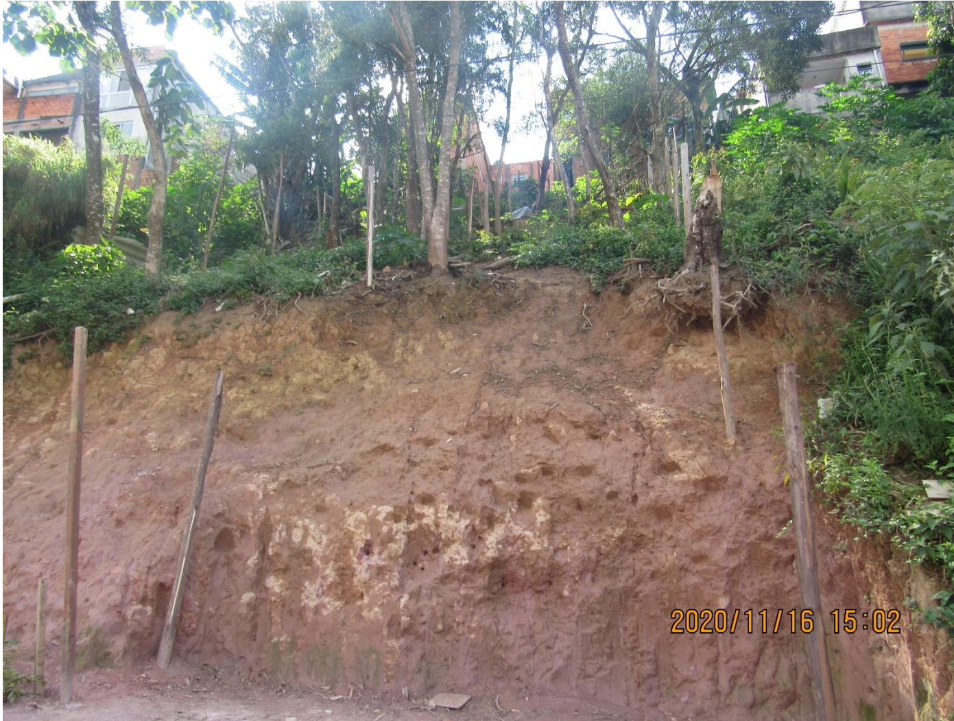
FC-SBC33_S2-03 – Corte executado, aparentemente, para instalação de uma edificação na Rua das Araras.
