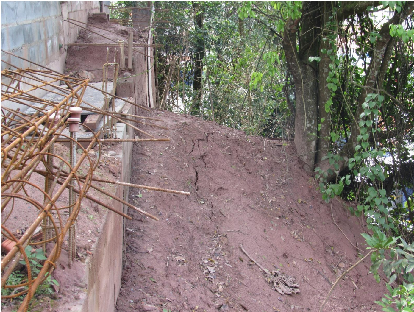
FC-SBC21_S1-01 – Destaque para as trincas no solo lançado a jusante da última edificação da Rua Genival Francisco da Silva. Material proveniente da expansão da edificação.
