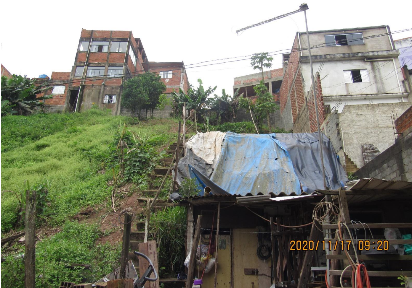
FC-SBC38_S1-02 – Destaque para lonas atrás da edificação (talude de corte), a moradia foi indicada para acompanhamento pelo PPDC.
