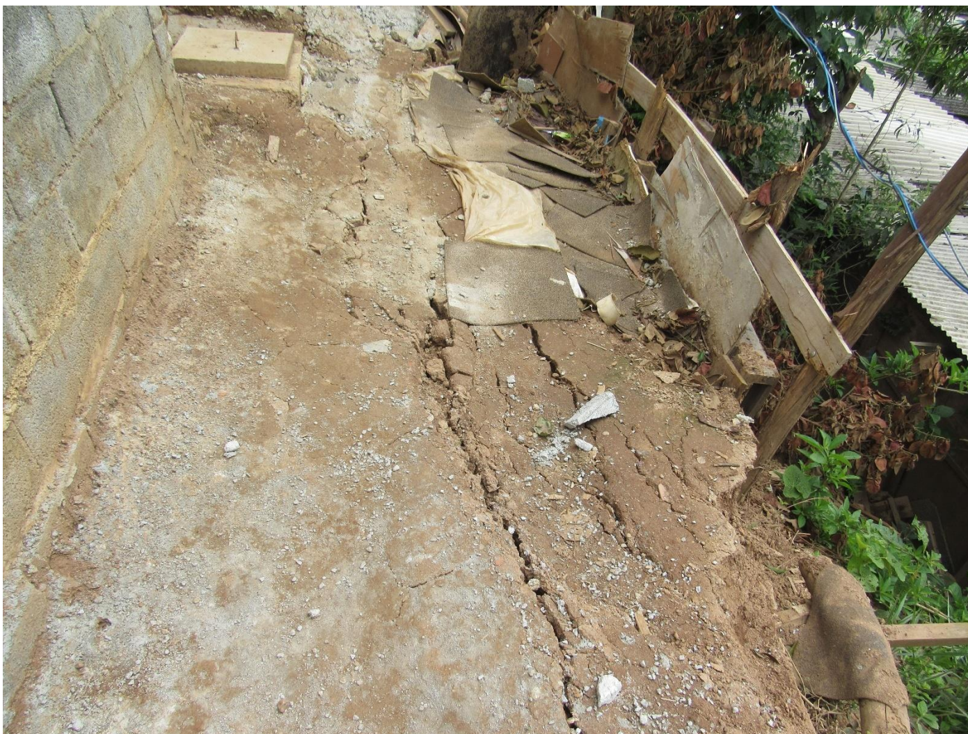
FC-SBC44_S2-03 – Trincas no terreno próximas à crista da encosta.
