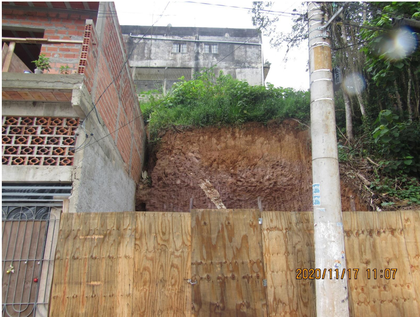
FC-SBC36_S1-01 – Destaque para talude de corte realizado para construção de uma nova moradia.
