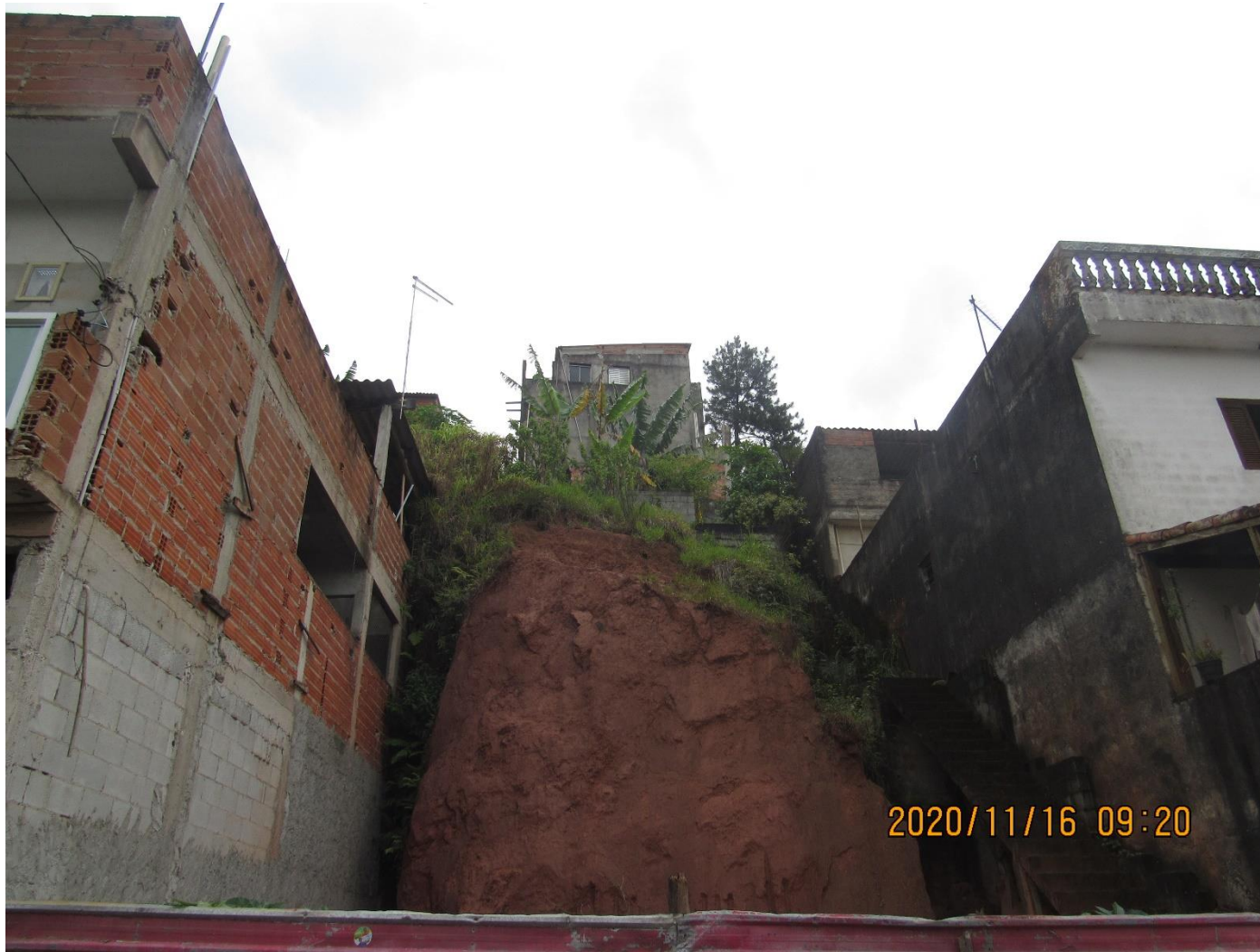
FC-SBC45_S5-01 – Destaque para corte executado na base da encosta com a Rua Simón Bolívar.
