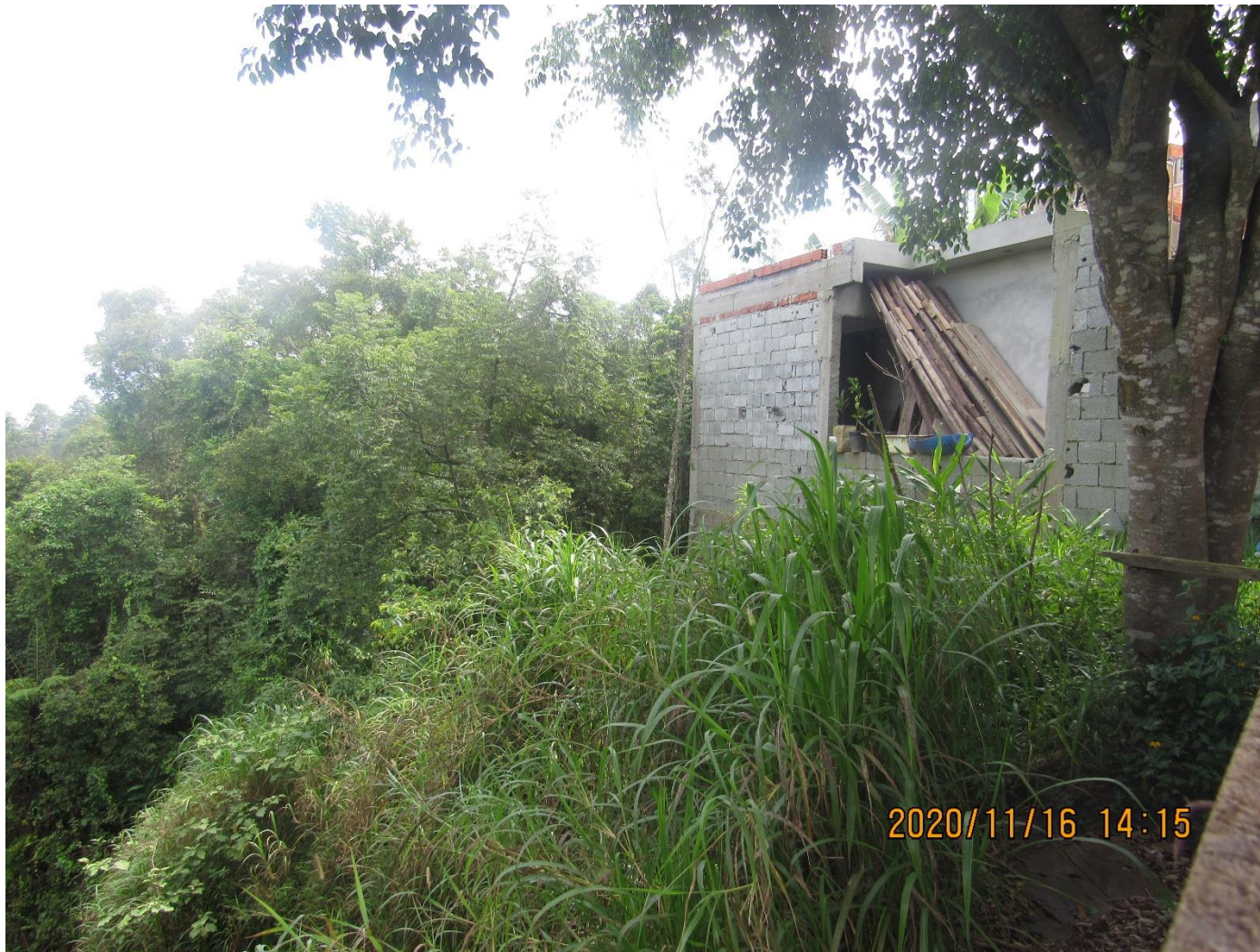
FC-SBC33_S1-01 – Vista da última casa da Rua das Andorinhas, a edificação está próxima da crista.
