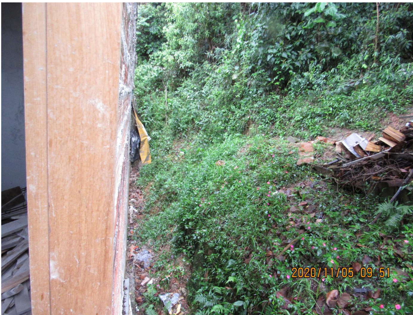
FC-SBC30_S1-02 – Destaque para distância entre a última casa da Rua Serra da Santa Maria (fim da rua) e a encosta. Possível local com material depositado.
