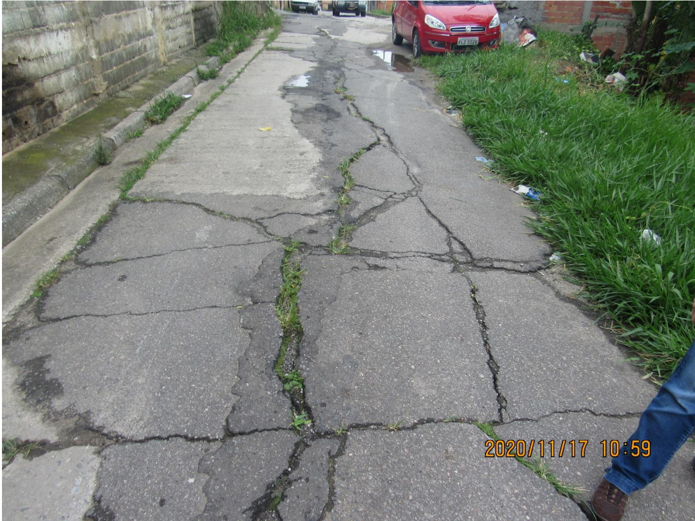
FC-SBC36_S2-02 – Destaque para as trincas na Rua Araponga.
