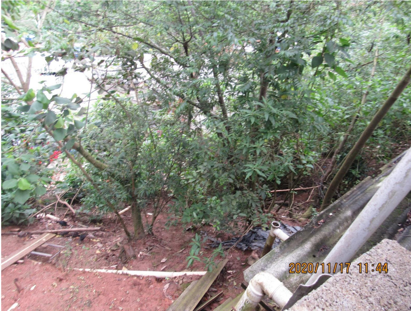
FC-SBC37_S1-02 – Destaque para solo depositado na crista da encosta (aterro mal compactado).
