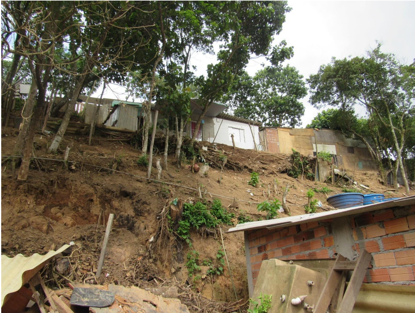
FC-SBC44_S2-01 – Destaque para situação da encosta com solo exposto, cicatriz de deslizamento, árvores inclinadas e material depositado na crista da encosta (solo).
