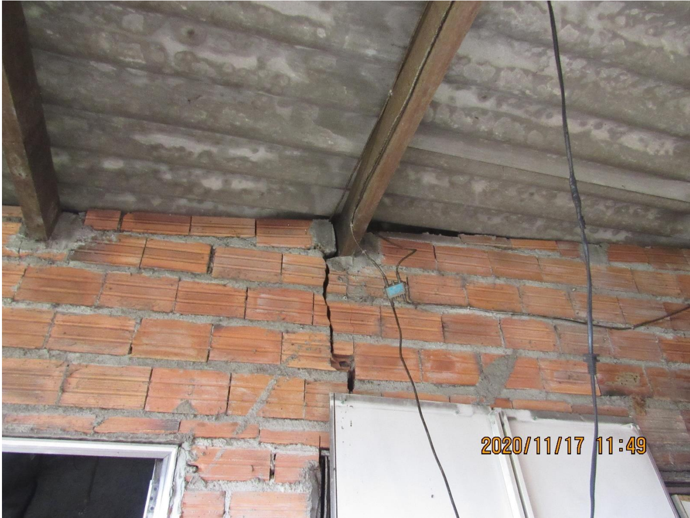
FC-SBC37_S2-02 – Destaque para as trincas na parede da casa indicada na foto FC-SBC36_S2-01.
