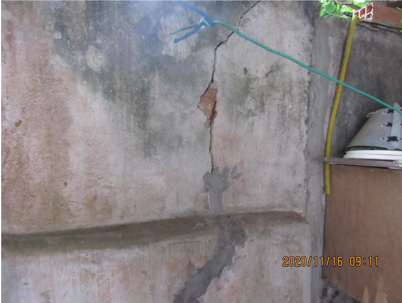
FC-SBC45_S3-02 – Trincas relacionadas possivelmente à movimentação do aterro, em uma das moradias mais próxima da crista da encosta.
