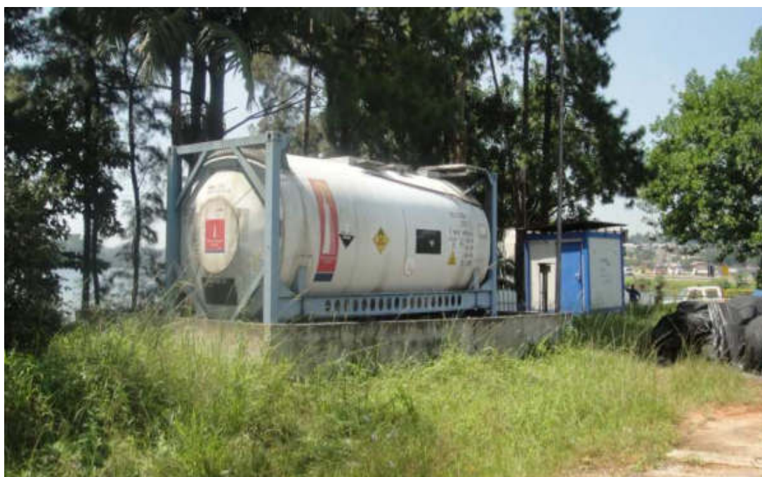
Figura 40 - Vista geral do sistema de estocagem de peróxido de hidrogênio instalado junto à captação de água bruta - Reservatório do Rio Grande
