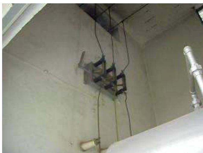
Figura 148 - Chave seccionadora sem fusíveis
