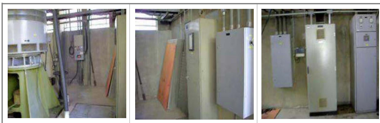
Figura 132 - Painéis da Controle, Automação e Serviços Auxiliares.
