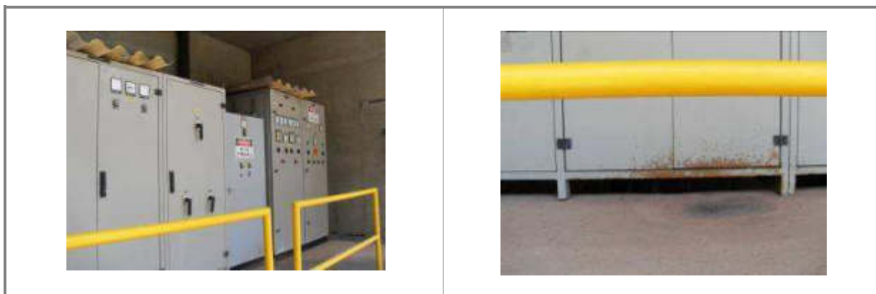
Figura 145 - Painel dos Geradores com Gotejamento na Laje e Detalhe de Vão sob o Painel
