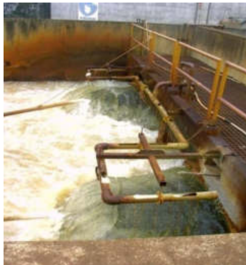
Figura 59 – Detalhe da vista geral da unidade de mistura rápida em operação na ETA Rio Grande.
