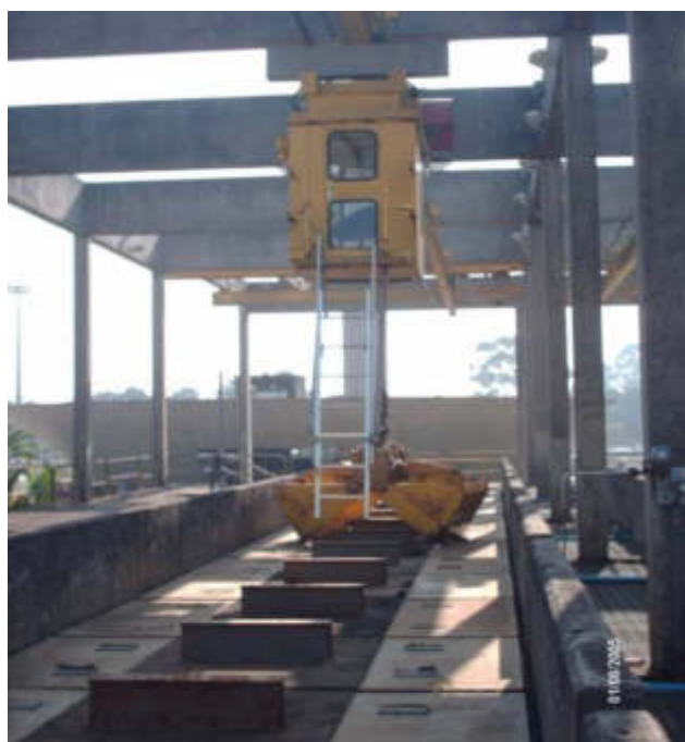
Figura 92 - Vista do canal desarenador, com destaque para o dispositivo de remoção de areia tipo “clam-shell”
