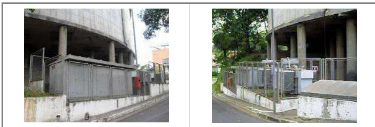
Figura 134 - SE da ETA Nova, em Cabine Blindada
