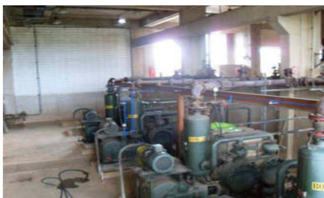
Figura 168 - Bombas com Alta Incidência de Manutenção
