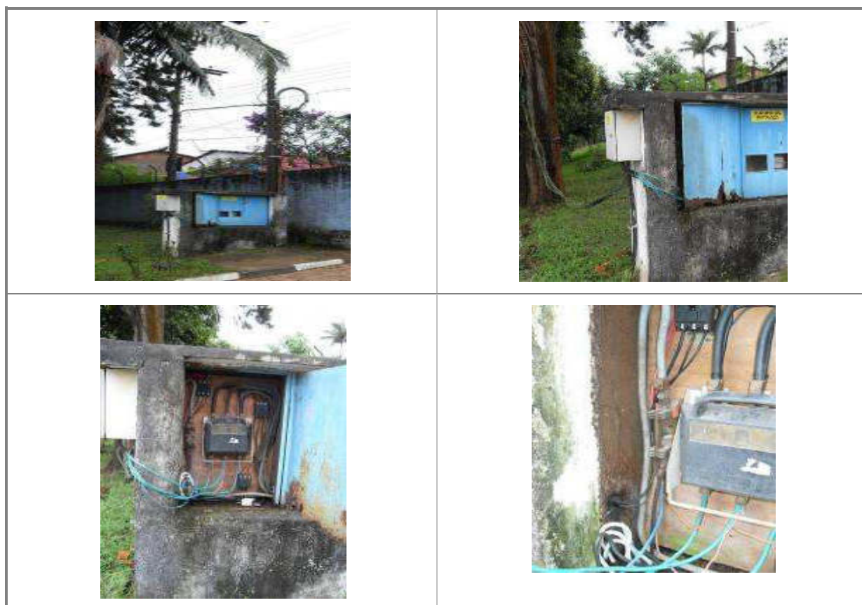
Figura 150 – Entrada de Energia
