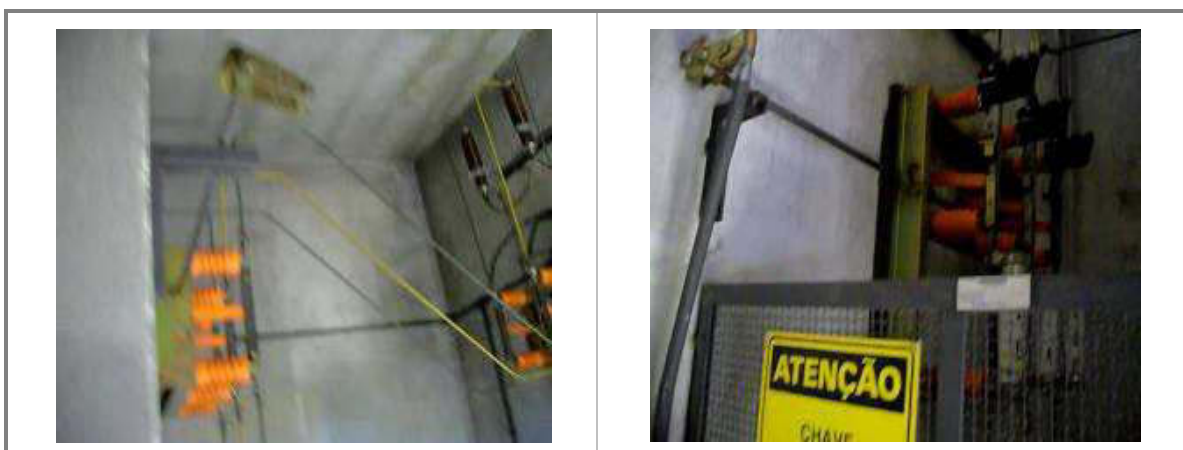
Figura 171 - Chave seccionadora sem mecanismo de manobra e sem fusíveis no trafo de 500 kVA (esquerda) e Chave com Fusíveis e Manobra no Trafo Auxiliar
