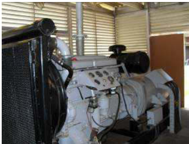
Figura 149 - Gerador de Emergência
