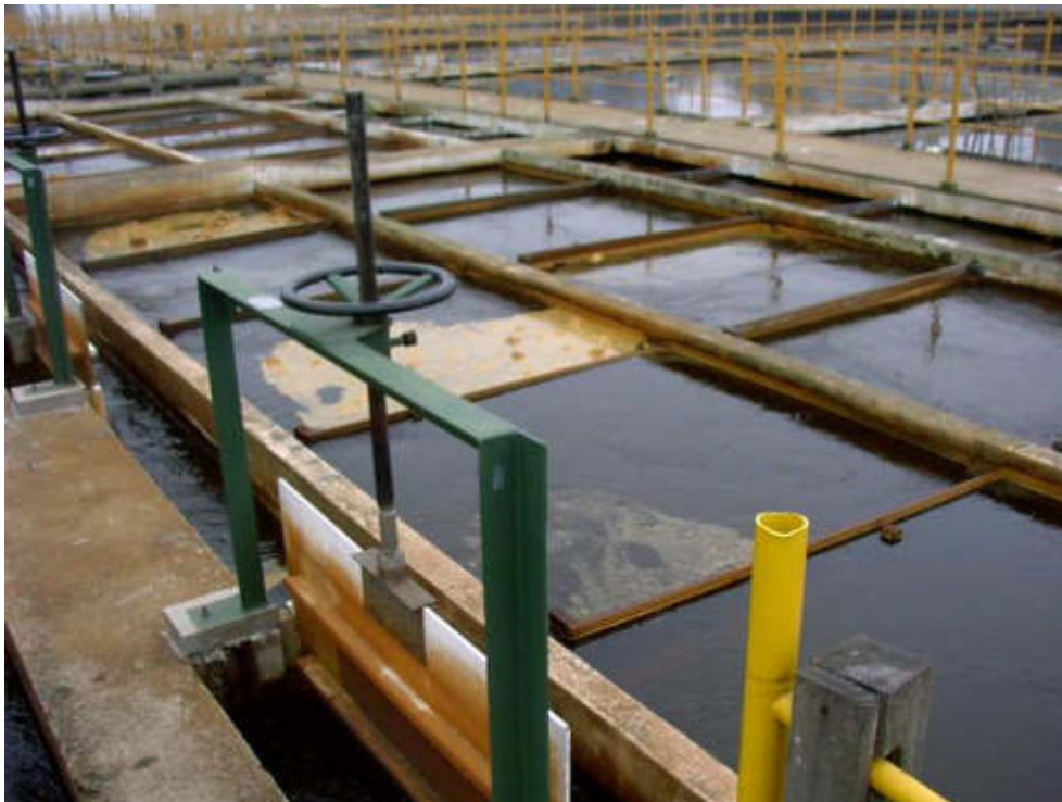
Figura 64 - Vista geral dos floculadores que compõem a “Ala Velha”
