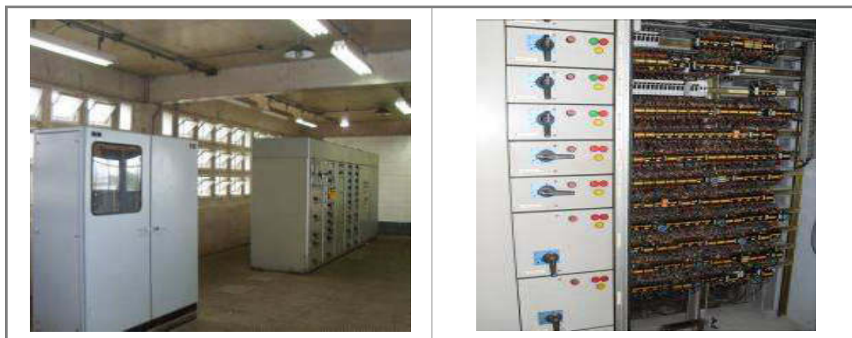
Figura 169 – Sala de Controle e Painéis
