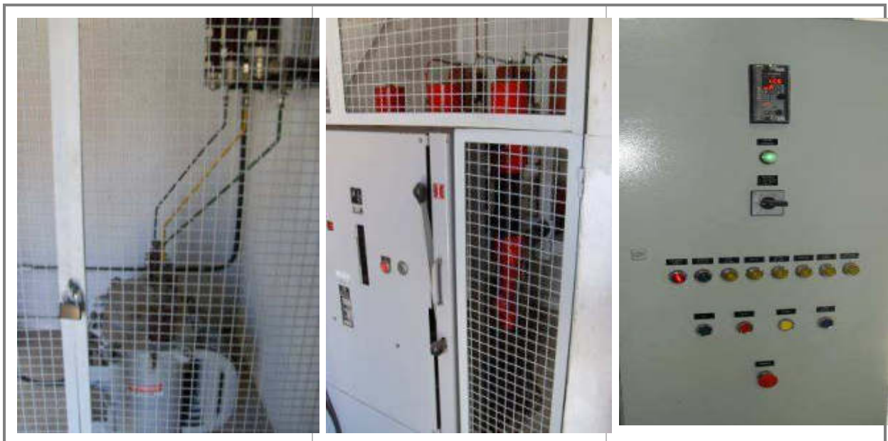
Figura 176 - Cella do Trafo Auxiliar (esquerda); Cella do Disjuntor a Pequeno Volume de Óleo (centro) e PDCR
