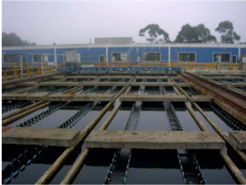
Figura 71 – Outra vista dos decantadores que compõem a “Ala Nova”
