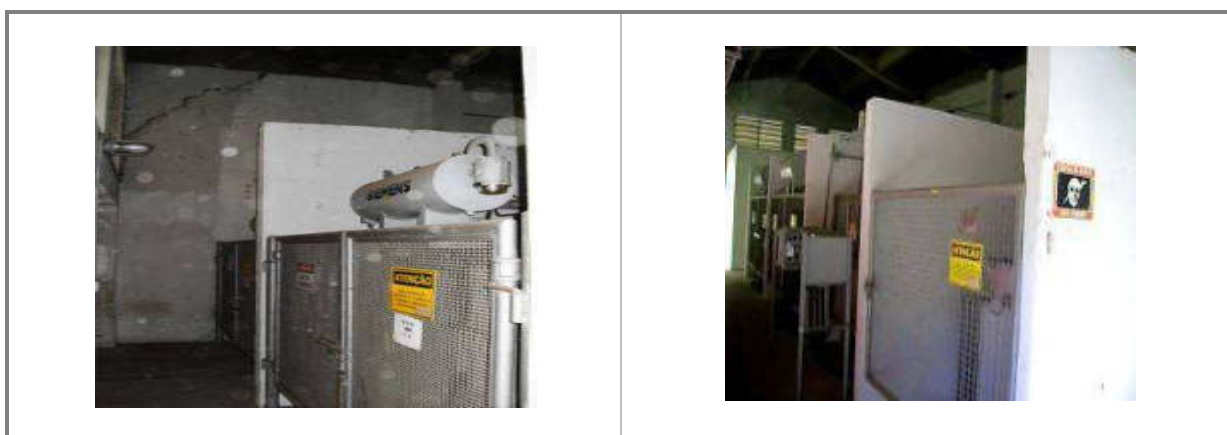
Figura 124 - Sala de Trafos: 2 Trafos de 1500 kVA e 2 Trafos de 1500 kVA, Capacitores e TR Auxiliar
