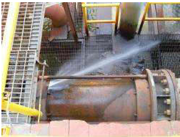
Figura 133 - Vazamento no Recalque
