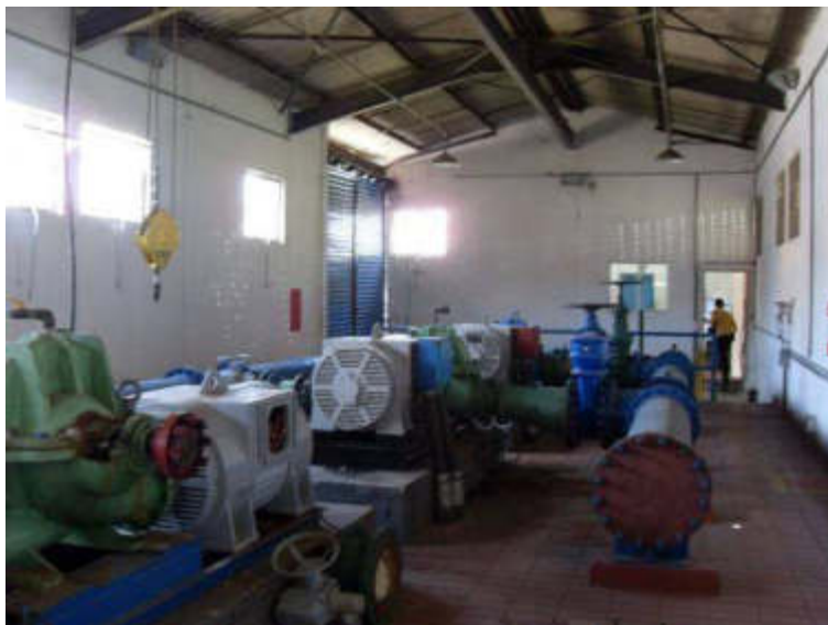
Figura 174 - Vista das Moto-Bomba de 430 CV, 1730 rpm
