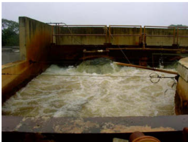
Figura 60 - Vista geral da unidade de mistura rápida em operação na ETA Rio Grande.
