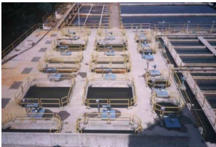
Figura 66 - Vista geral dos floculadores que compõem a “Ala Nova”
