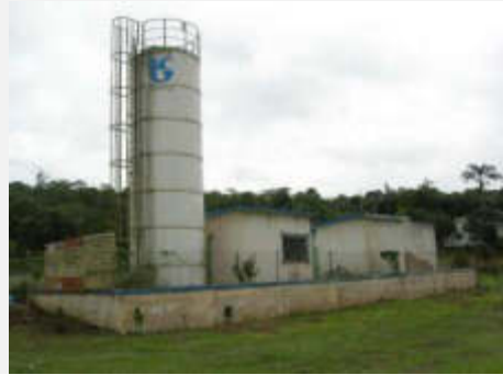
Bairro Santa Cruz – Poço com tratamento para remoção de ferro e manganês
