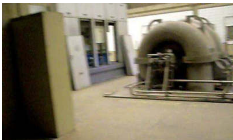
Figura 167 – Vista do Soprador de 3500 CV e do Conjunto de 900 CV (esquerda)
