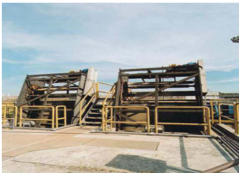
Figura 91 - Vista do gradeamento médio da ETE ABC
