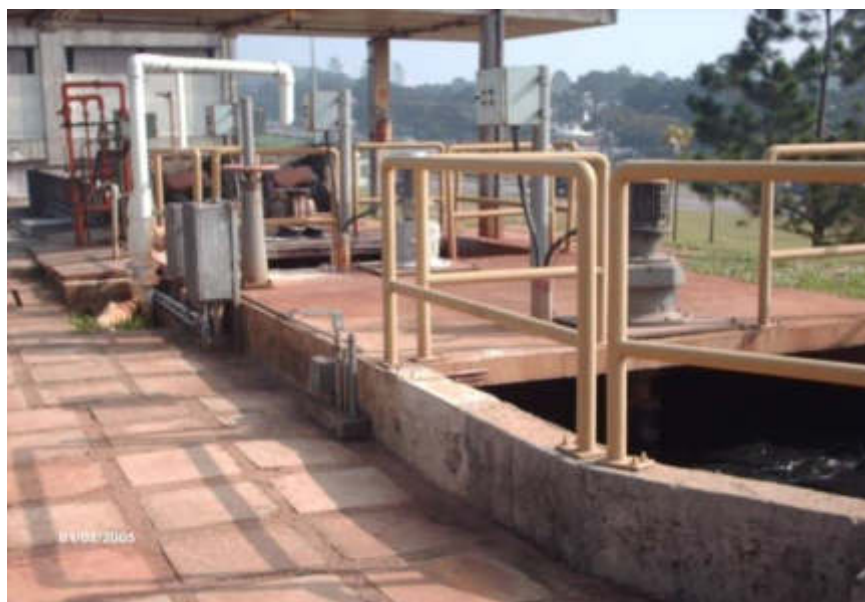
Figura 99 - Vista do sistema de flocculação química do lodo digerido
