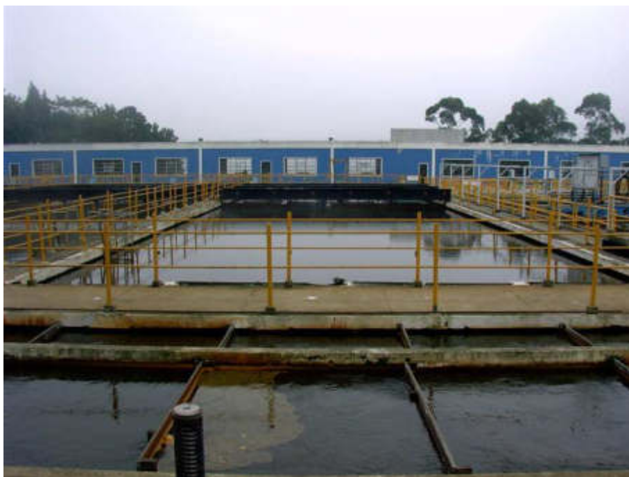
Figura 68 - Vista geral dos decantadores que compõem a “Ala Velha”
