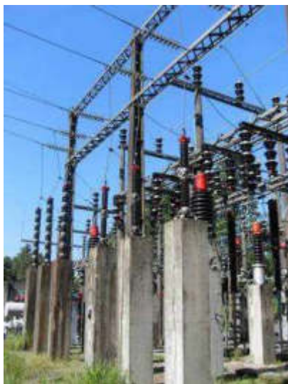
Figura 117 - Alimentação da SE – Circuito duplo 88kV e estado de conservação
