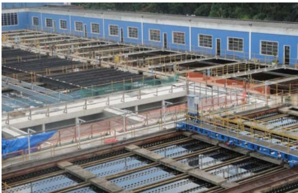
Figura 72 - Vista geral do decantador 7 pertencente a “Ala Velha” atualmente em fase de reforma: transformação em unidade de flotação com ar dissolvido
