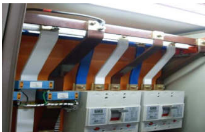
Figura 178 – Painel do banco de capacitores sem proteção nos barramentos
