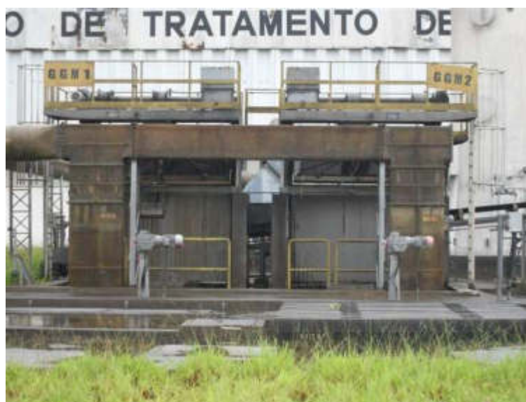
Figura 90 - Vista do gradeamento grosseiro da ETE ABC
