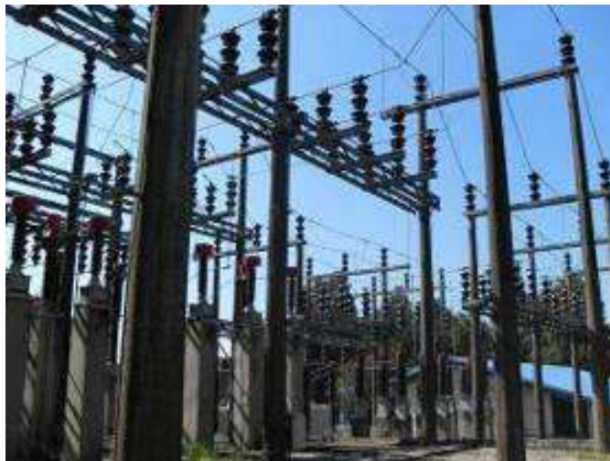
Figura 119 - Vista da SE e Sala de Controle
