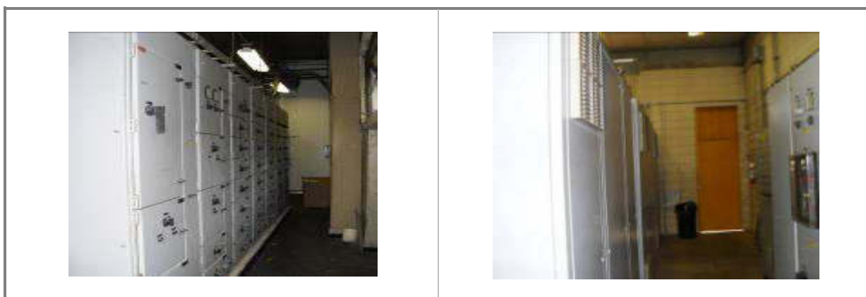
Figura 143 - Painel de Distribuição de Serviços Auxiliares
