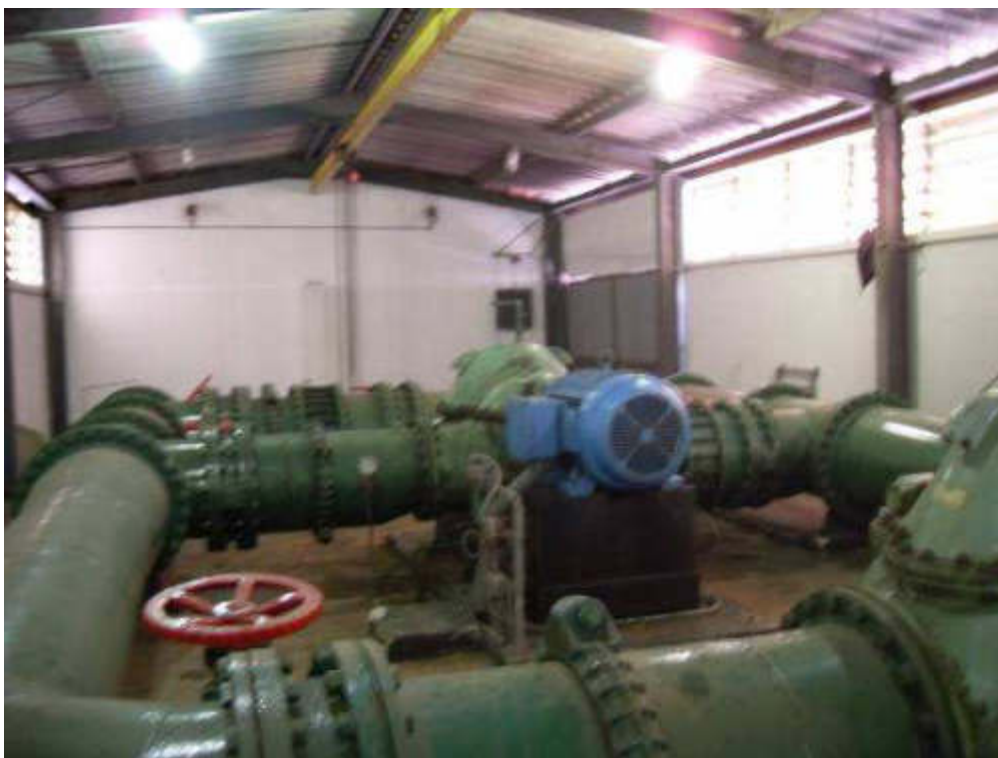
Figura 172 - Sala de Bombas, Barrilete de Sucção e Recalque
