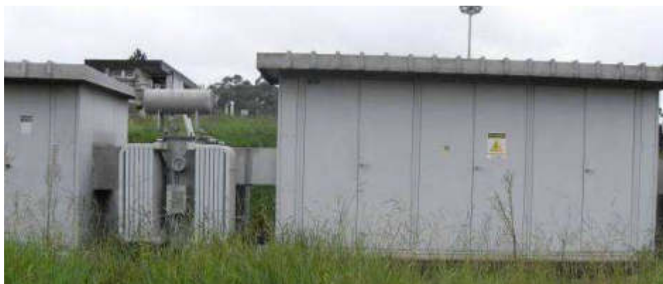
Figura 158 - Subestação Unitária, distribuídas na área nos vários centros de carga
