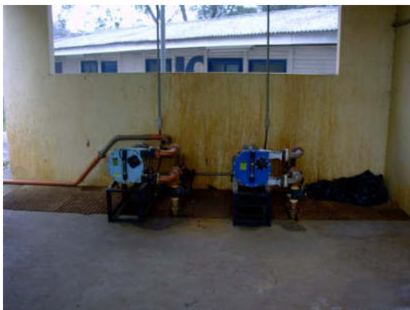
Figura 62 – Vista geral das bombas de dosagem de produtos químicos
