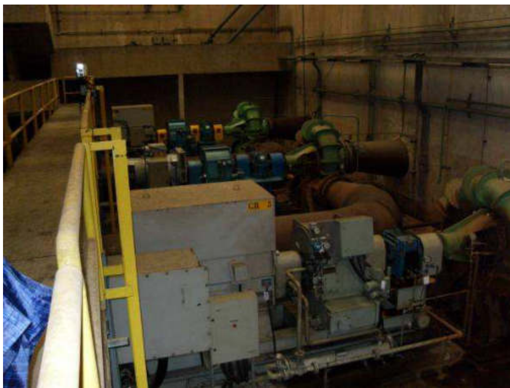
Figura 161 - Conjuntos Moto-Bomba de 950 CV
