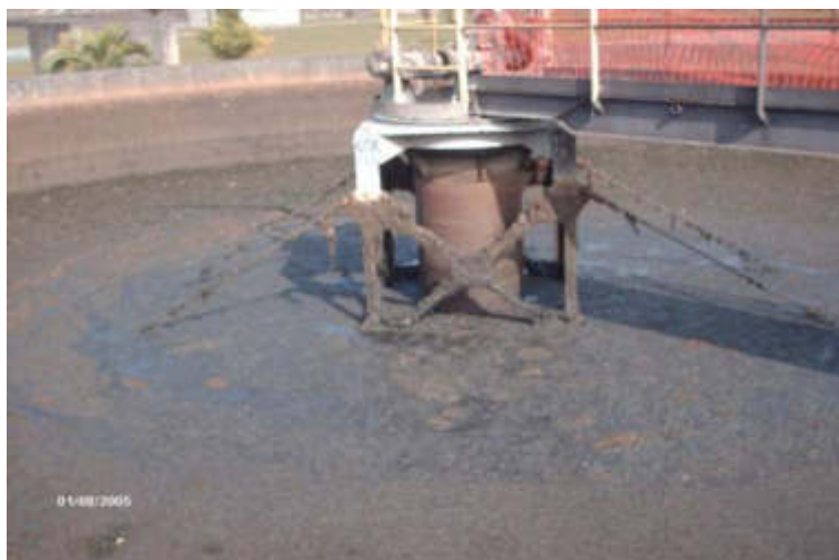
Figura 100 - Tanque de lodo condicionado
