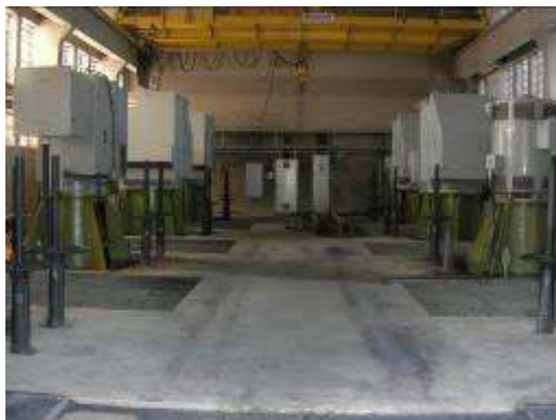
Figura 130 – Casa de bombas
