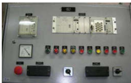
Figura 126 – Painel dos relés de proteção
