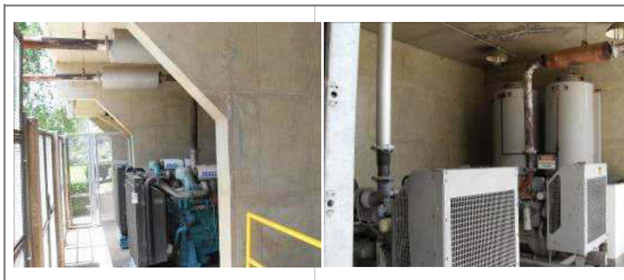
Figura 144 - Geradores de 400 kVA (esquerda) e 230 kVA (direita)
