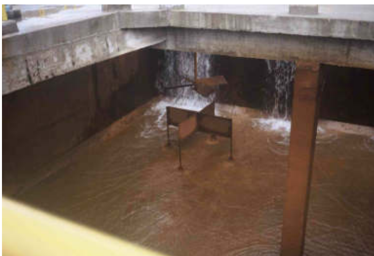
Figura 67 – Detalhe dos floculadores que compõem a “Ala Nova”
