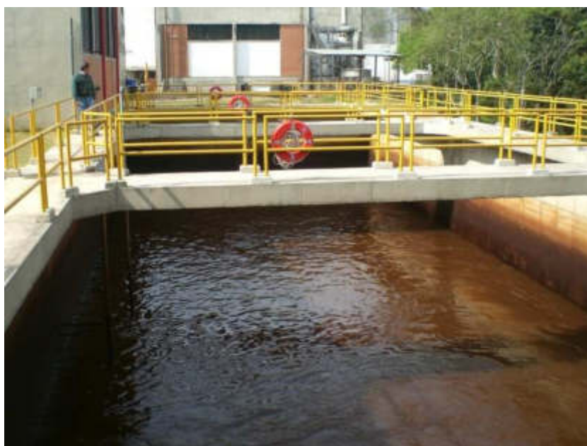
Figura 78 – Vista geral do sistema de recuperação de água de lavagem dos filtros da ETA Rio Grande.
