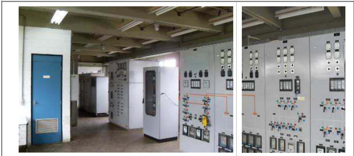
Figura 159 - Painel de Controle da SE, Sistema de Aquisição de Dados
