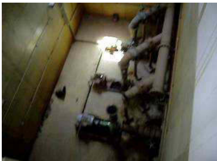
Figura 138 - Elevatória de Água do Sistema de Lavagem de Filtros
