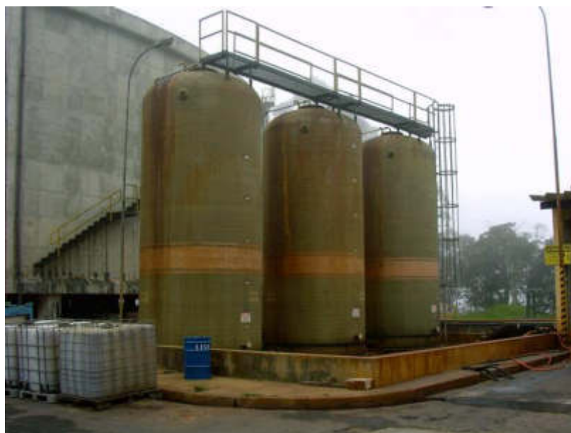
Figura 61 - Vista geral dos tanques de armazenagem de coagulante
