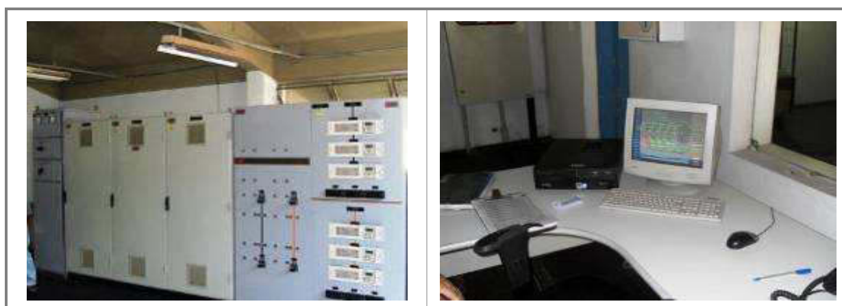
Figura 121 - Sala de Controle: Painéis e Estação de Operação
