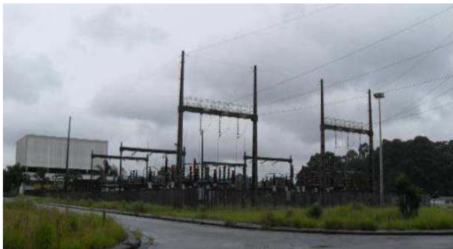
Figura 156 - Entrada da SE com Circuito Duplo
