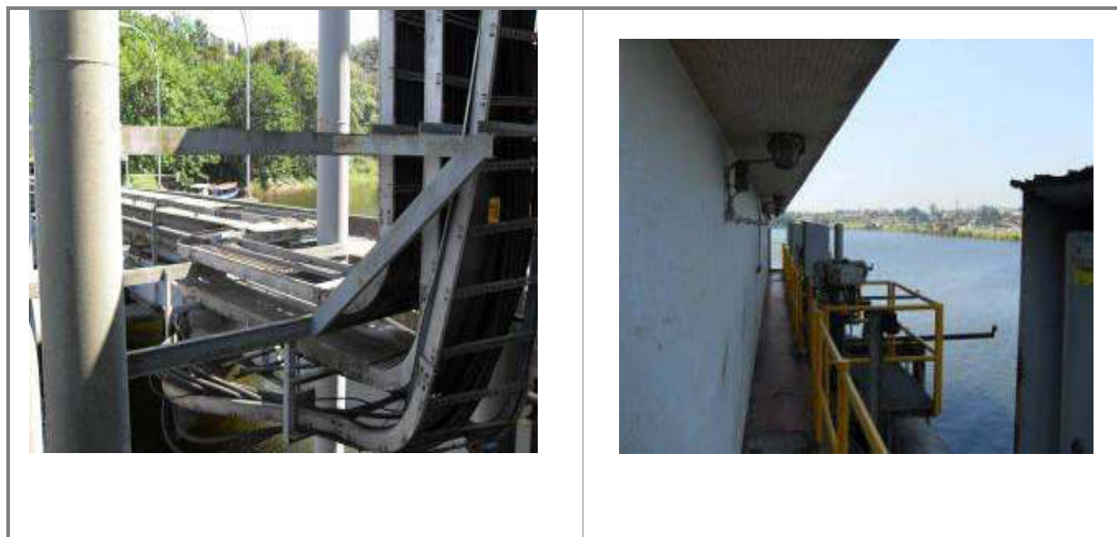
Figura 131 - Cabos de Energia na Elevatória/Casa de Bombas
