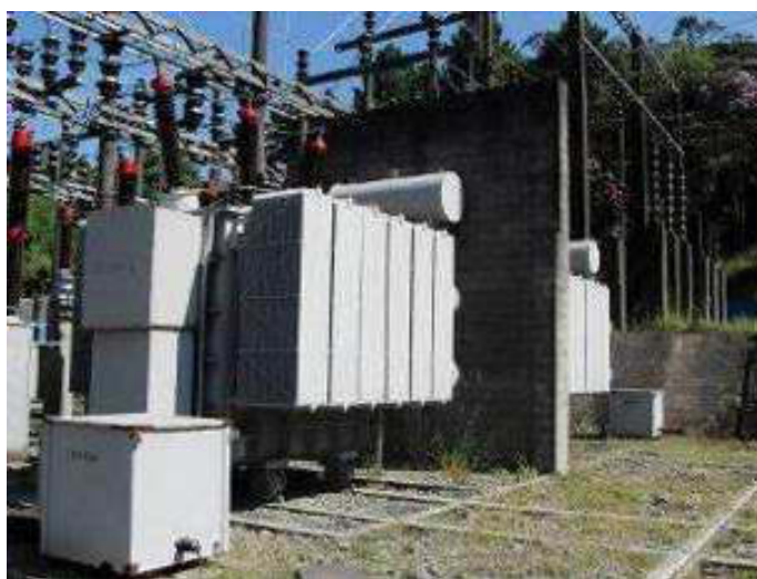
Figura 114 - Trafo e resistor de aterramento
