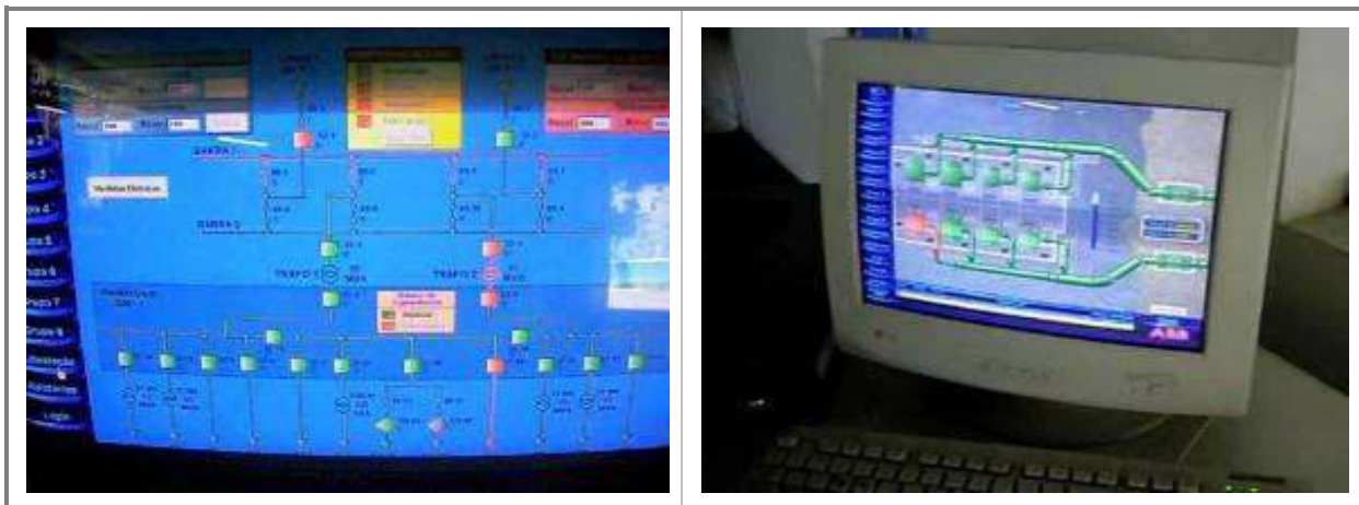
Figura 122 - Fotos das telas da SE-AT e Distribuição de 13,8 kV e da Elevatória, com um trafo de 15 MVA e um conjunto moto-bomba de 1400CV desligados (indicação em vermelho).
