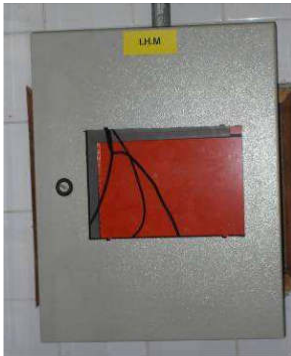
Figura 152 – Interface Homem-Máquina (Danificada)
