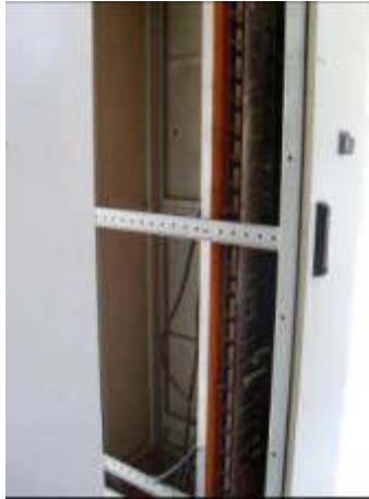
Figura 181 – Painel de serviços auxiliares (PSA) sem tampa de fechamento lateral
