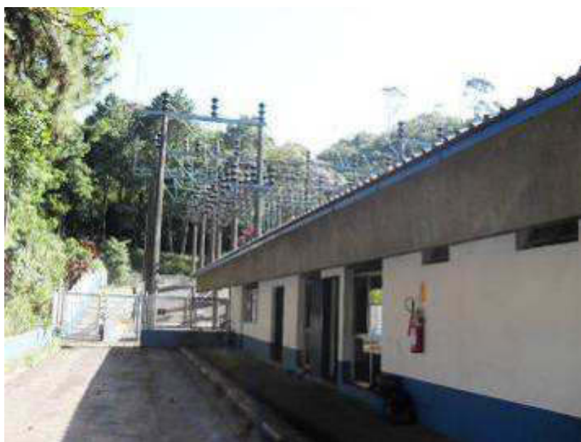
Figura 112 - Casa de Controle e Subestação
