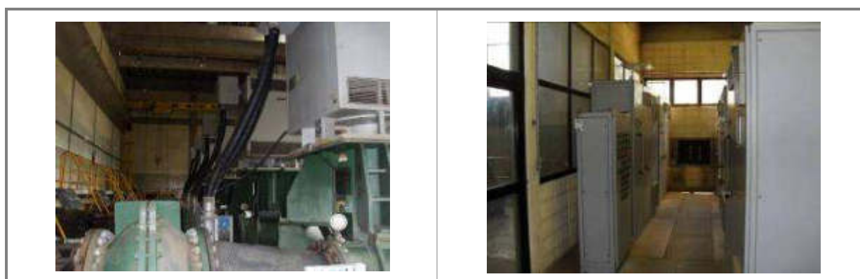
Figura 137 - EAT: 5 Conjuntos Moto-Bomba de 350 CV (4+1), e CCM com Inversores de 350 CV
