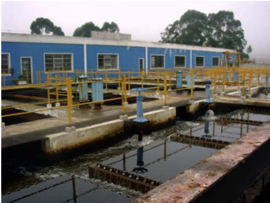
Figura 74 - Vista geral dos filtros pertencentes a “Ala Velha” da ETA Rio Grande
