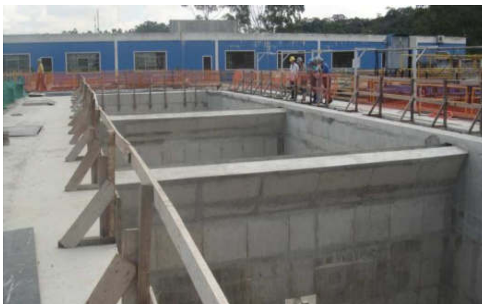
Figura 73 – Detalhe construtivo do decantador 7 pertencente a “Ala Velha” atualmente em fase de reforma: transformação em unidade de flotação com ar dissolvido
