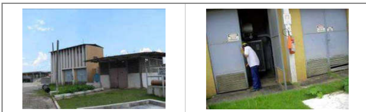
Figura 135 - SE da ETA Antiga: Cabine de Alvenaria e Sala do Grupo Gerador
