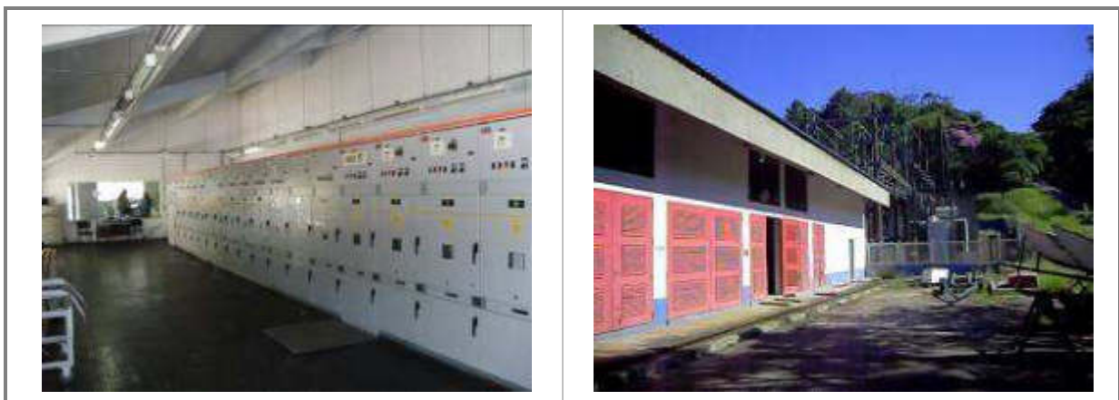
Figura 123 - Sala dos Cubículos de Distribuição 13,8 kV e Vista Externa da Sala de Trafos
