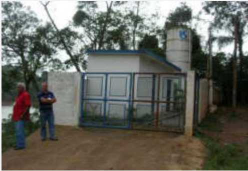
Bairro Tatetos – Poço com tratamento para remoção de ferro e manganês
