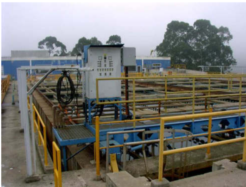
Figura 70 - Vista geral dos decantadores que compõem a “Ala Nova”
