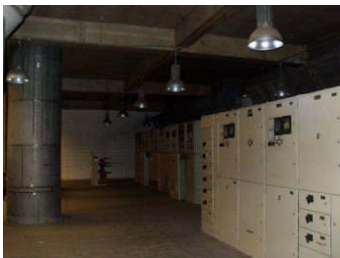
Figura 165 - Cubículos de MT ao Fundo e de Baixa Tensão/460V
