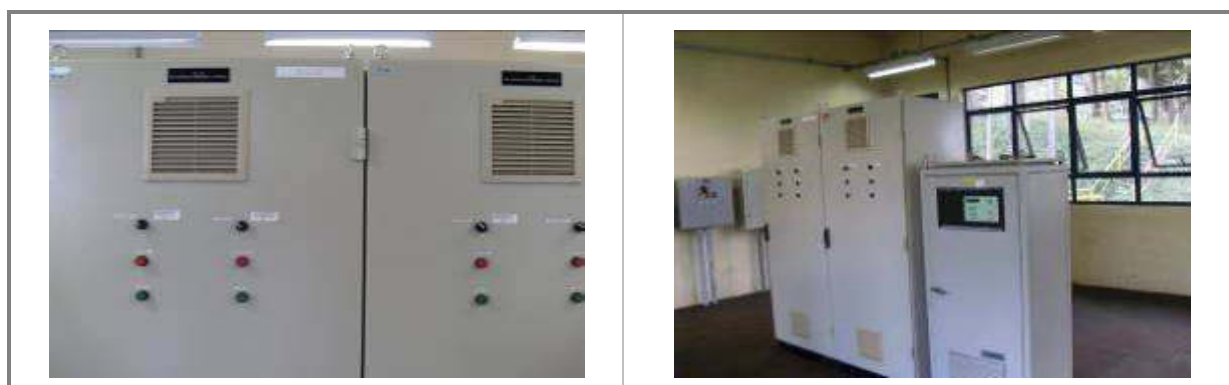
Figura 127 - Sistema de Aquisição de Dados/Automação e Conjunto Retificador/Carregador de Bateria
