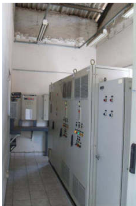
Figura 177 – Vista em primeiro plano do painel de proteção do banco de capacitores, ao Lado o CCM (PCM-PCM-E, PCE), ao Fundo Painel CC, Telemetria e Unidade Remota (vista parcial).
