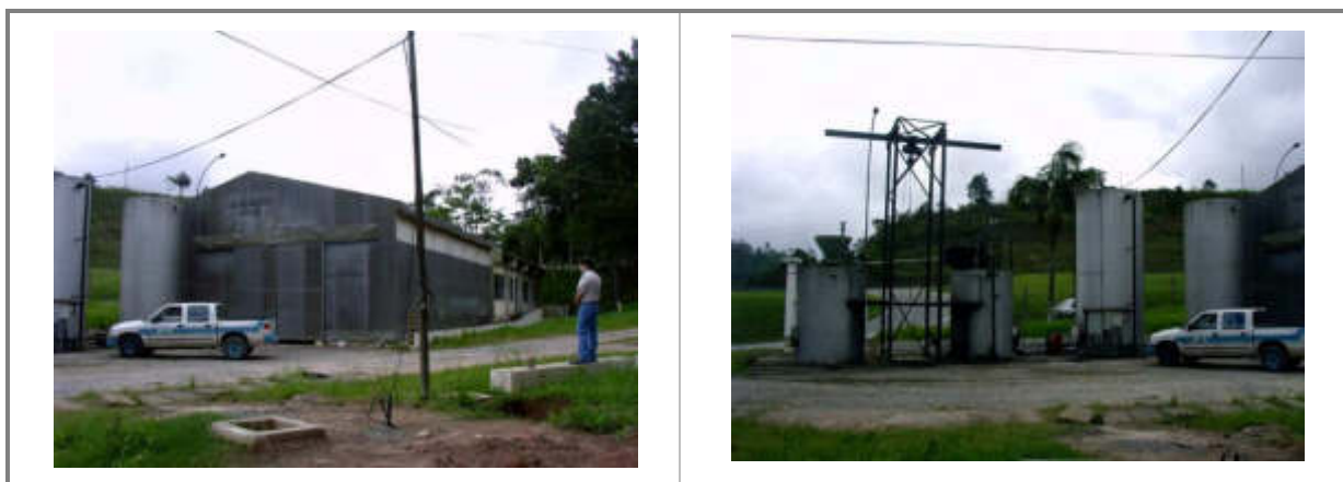
Figura 57 - Vista geral do sistema de preparo e dosagem de suspensão de CAP e solução de permanganato de potássio instalados junto à captação da ETA Rio Grande
