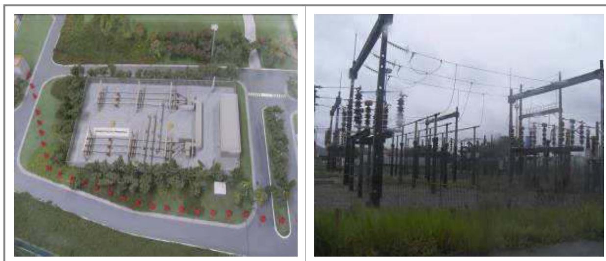
Figura 157 - Maquete da SE e Casa de Controle, e Vista Lateral da SE
