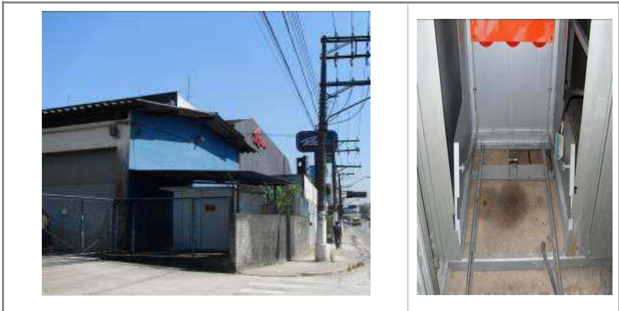
Figura 170 - Entrada e cubículo de entrada de energia (esquerda) e vista do cubículo sem disjuntor geral
