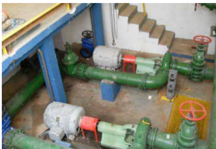
Figura 184 - Piso de Bombas, dois Conjuntos de 100 CV, 440 Vca
