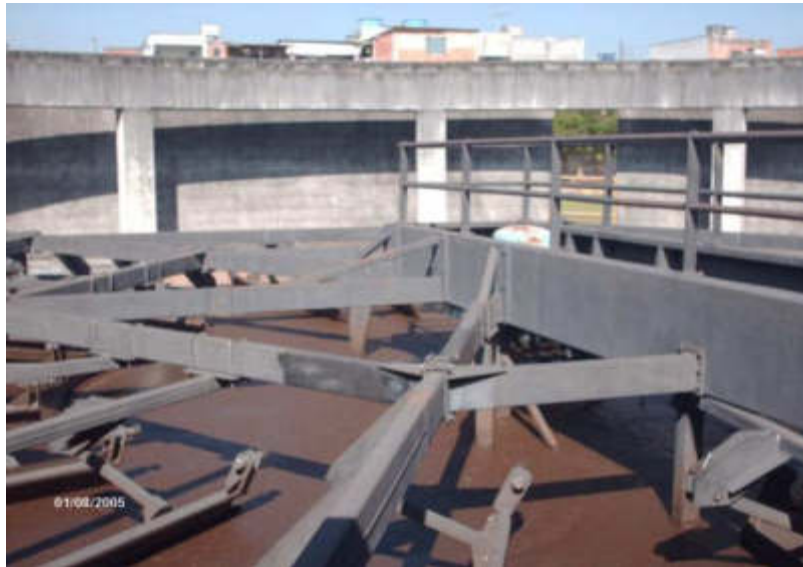
Figura 96 - Vista de um flotador da ETE ABC
