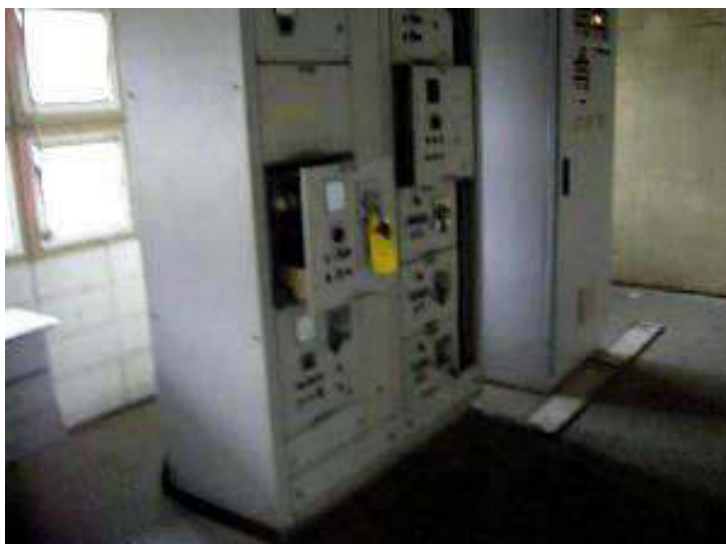
Figura 164 - CCM 440Vca da Elevatória I, Decantador Primário, Gaveta de Manutenção. Ao Lado do Inversor.
