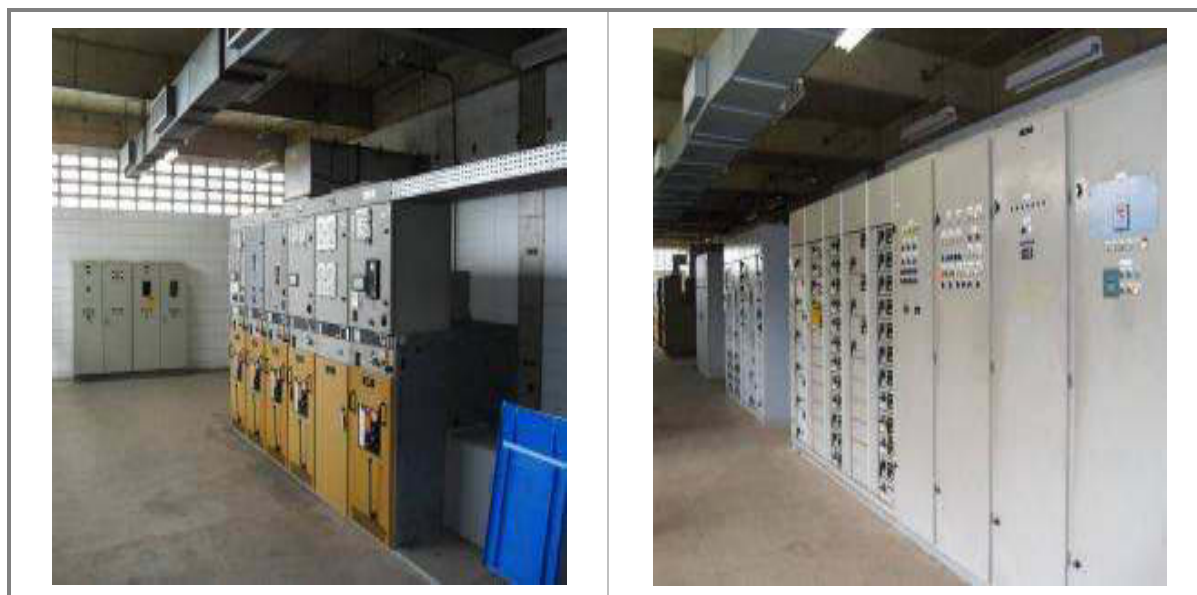
Figura 162 - Entrada, Distribuição e Acionamento MT (esquerda) e BT (direita)
