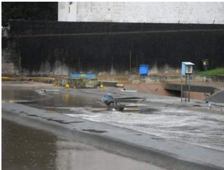
Figura 106 - Valo de oxidação da ETE Riacho Grande
