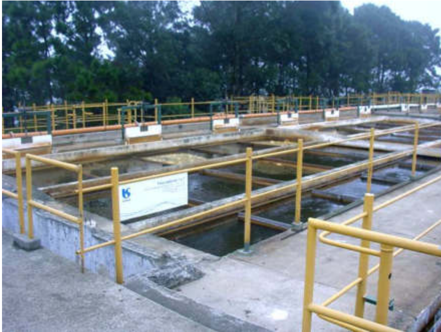
Figura 65 – Outra vista dos flocladores que compõem a “Ala Velha”
