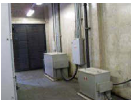
Figura 142 – Trafos da Casa de Química
