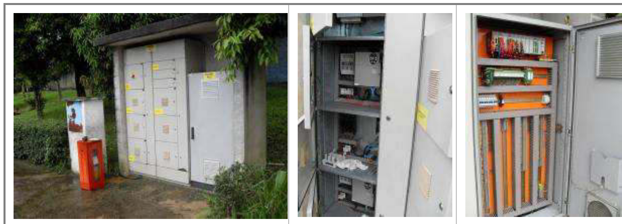
Figura 151 - CCM e Painel do CLP
