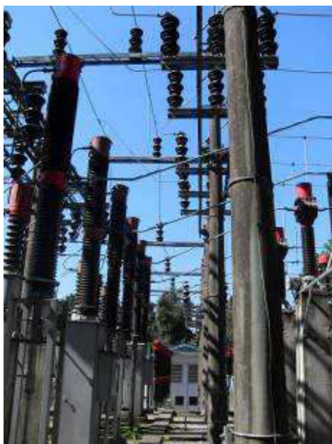
Figura 120 - Vista da SE com Sala de Controle ao fundo
