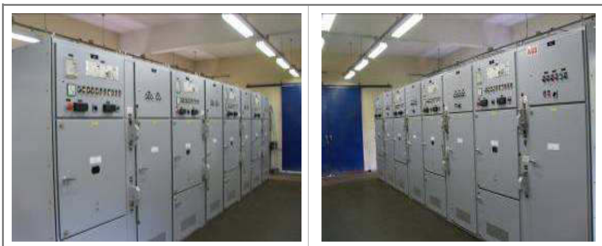
Figura 128 - CCM – “Face to Face”: Acionamentos e Cubículos de Proteção de Capacitores
