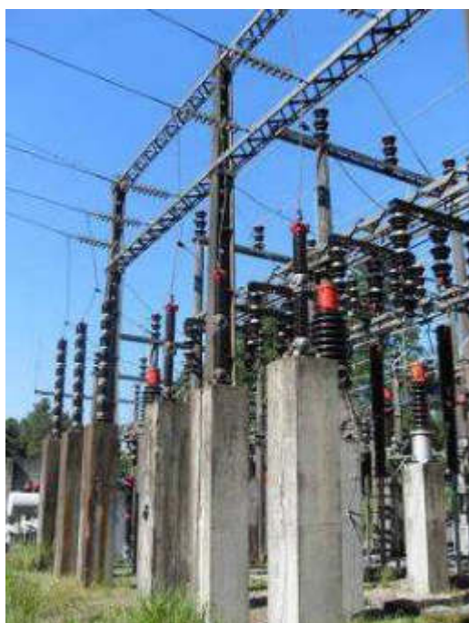
Figura 113 - Alimentação da SE – Circuito Duplo 88 kV
