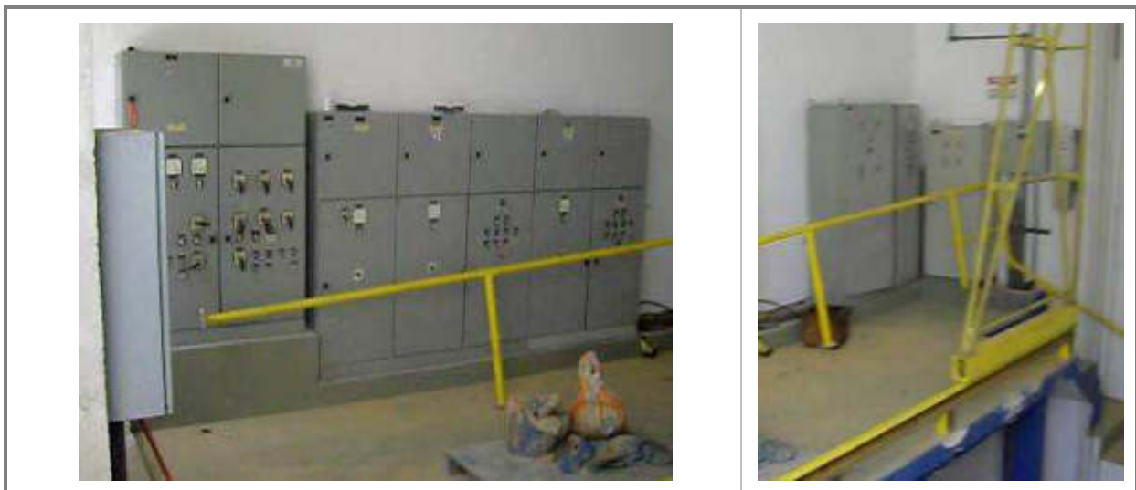
Figura 182 - Piso de Painéis, PSA, CCM Painel de Capacitores e Quadro de Luz
