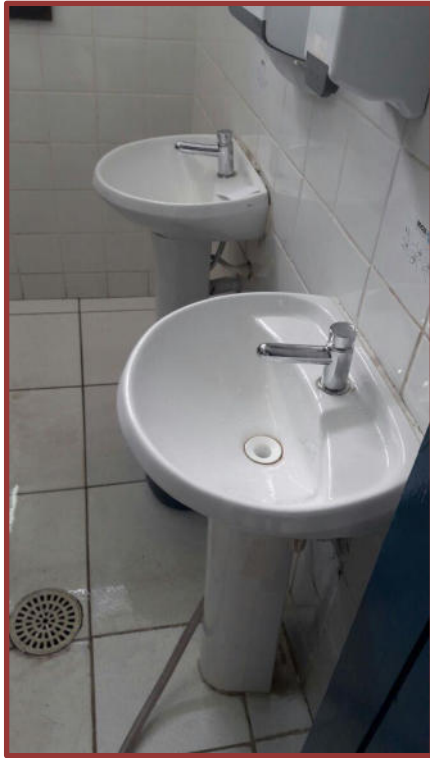
Figura 10 – Instalação de torneira de fechamento automático tipo mesa em banheiro de praça
