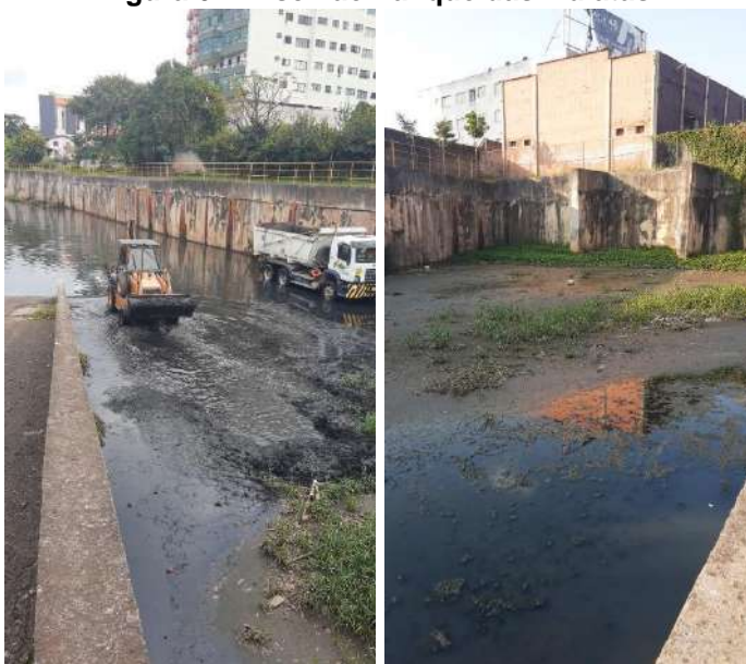
Figura 61: Piscinão Tanque das Mulatas.
